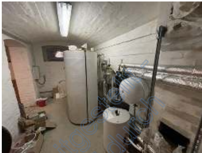
Geschwister-Scholl-Straße 10 - MFH - Keller mit Heizung:
