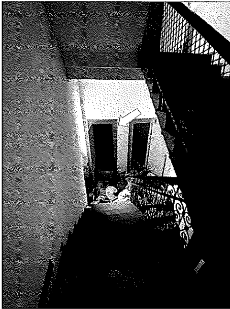
⇒ Abstellraum der Wohnung Nr. 3 im Treppenhaus, massive Müllab- lagerungen, ein Beispiel
