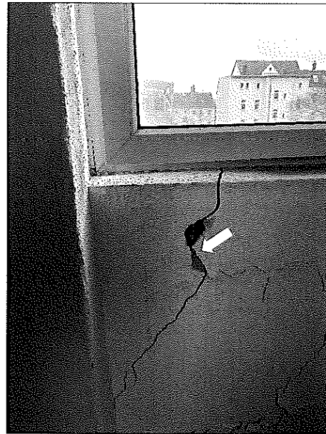
⇒ Spannungsriss im Treppenhaus, ein Beispiel
