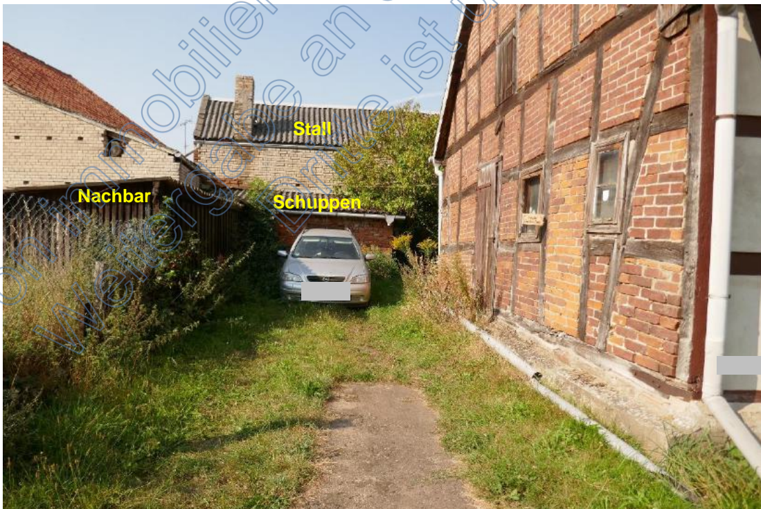
Foto 4, Schäden am Fachwerk und der Ziegelausmauerung der Gefache, Giebelwand Wirtschaftsbereich Einfamilienhaus, Nordostansicht
