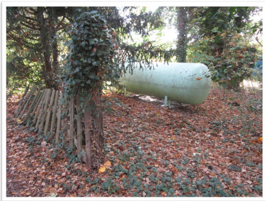
Bild 14: TG2 – Tank für Flüssiggas (Flurstück 82/2)
