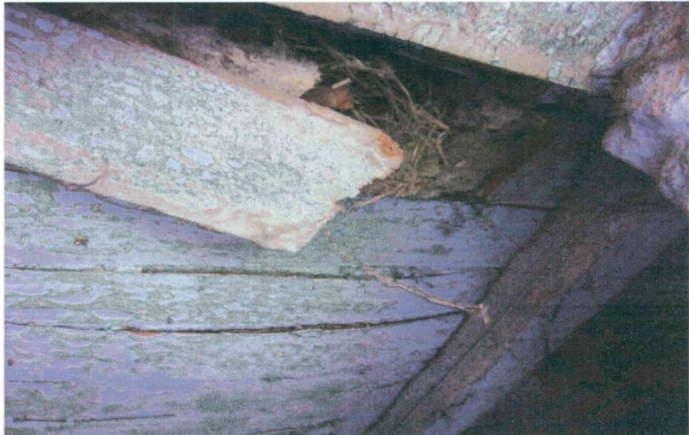
BILD 18: Hohenzitz, Im Winkel 4, Scheune, Schäden am Holz zu erkennen.
