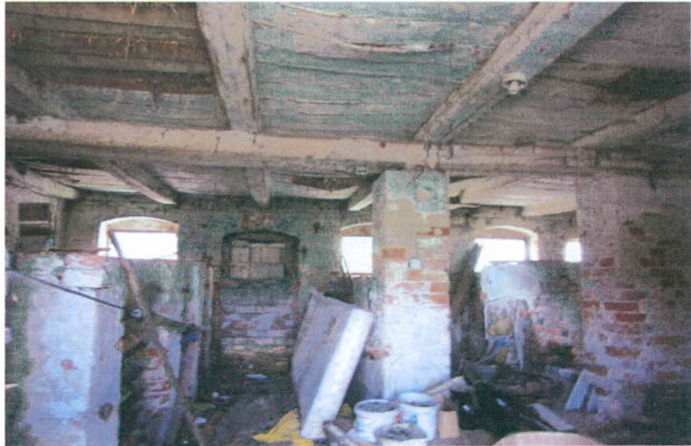
BILD 19: Hohenzitz, Im Winkel 4, Scheune, Schäden am Holz zu erkennen.
