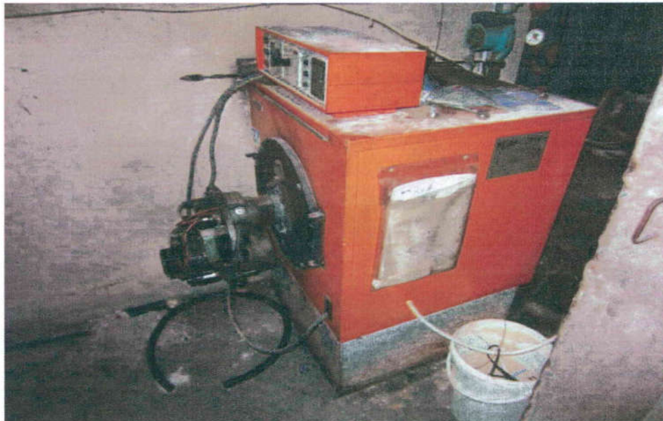
BILD 22: Hohenzitz, Im Winkel 4, Heizung
