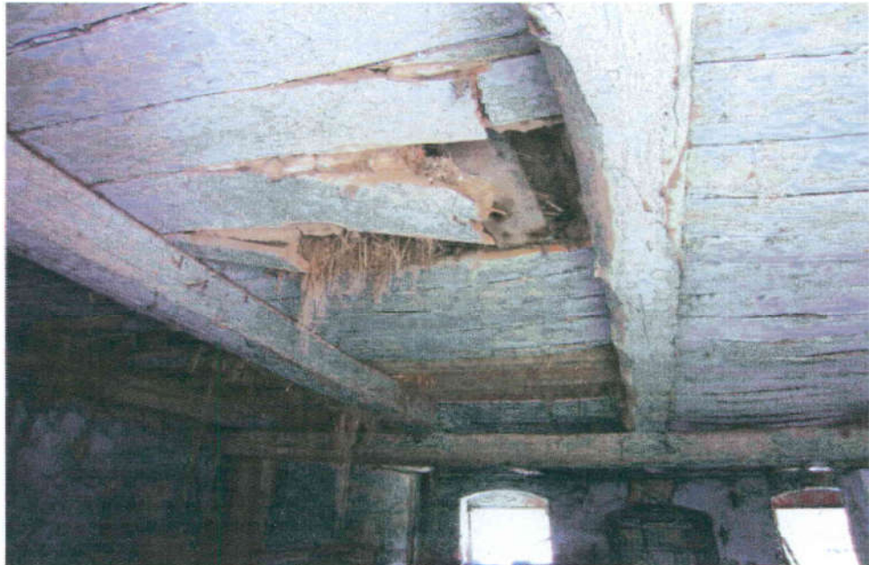
BILD 17: Hohenzitz, Im Winkel 4, Scheune, Schäden am Holz zu erkennen.
