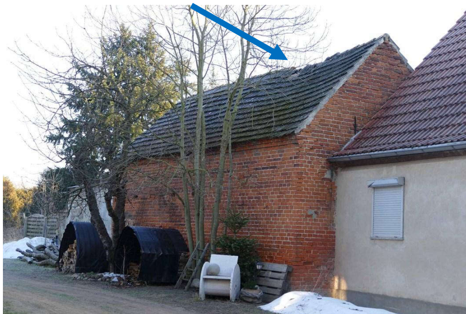
Bild 8: massives Nebengebäude mit defektem Dach
