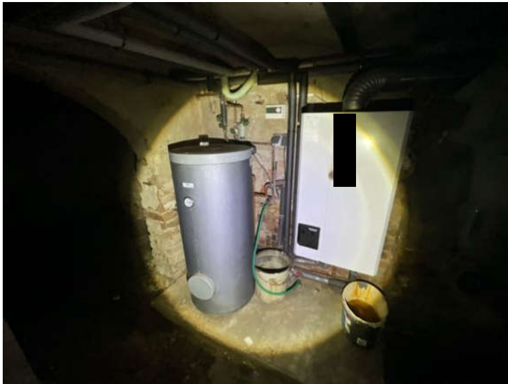
Bild 70: Kellerraum mit Heizungsanlage
