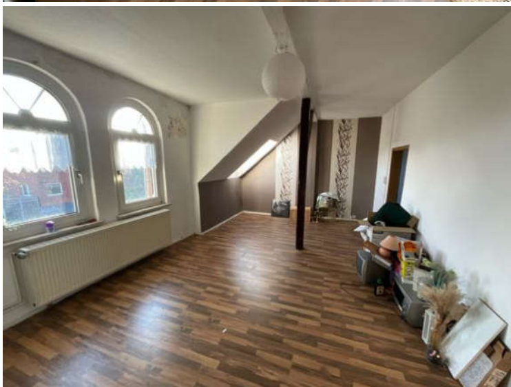
Bild 34: Wohnraum 3 (DG) mit Feuchte- und Sub- stanzschäden im Wand- und Fensterbereich
