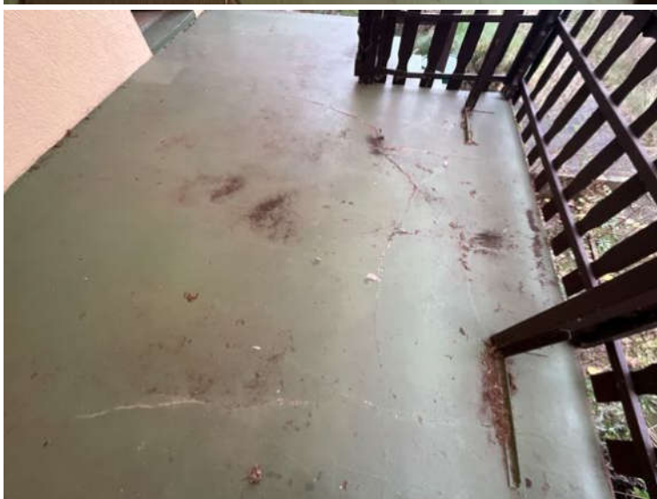
Bild 41: Substanzschäden im Bereich der Terrasse
