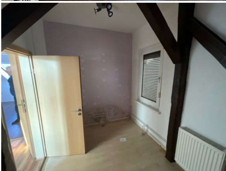
Bild 28: Wohnraum (DG) mit Feuchte- und Substanz- schäden im Wandbereich
