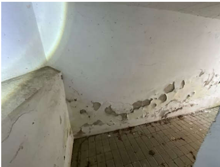
Bild 65: Zugang zum Kellergeschoss mit Feuchteschäden im Wandbereich
