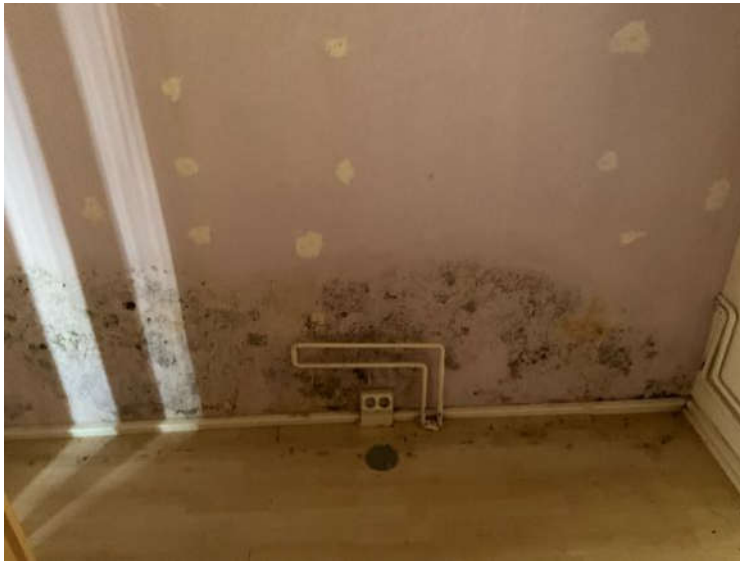
Bild 29: Wohnraum (DG) mit Feuchte- und Substanzschäden im Wandbereich
