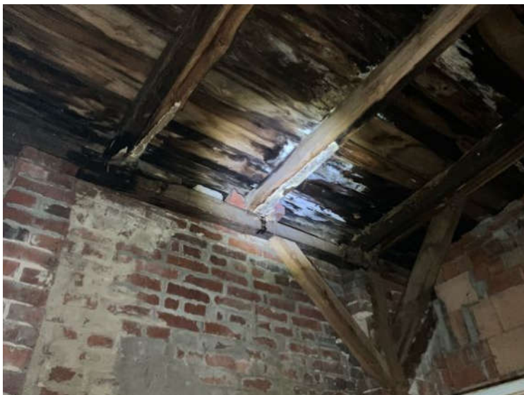
Bild 20: holzerstörender Pilzbefall im Dachbereich
