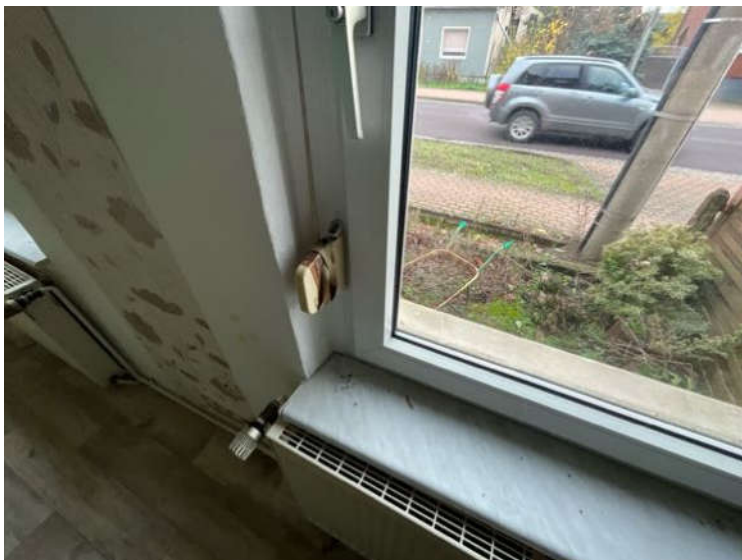
Bild 46: Wohnraum 1 (EG) mit Substanzschäden im Fensterbereich
