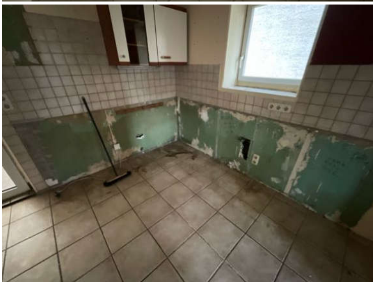
Bild 50: Küche (EG) mit Substanzschäden im Wandbereich
