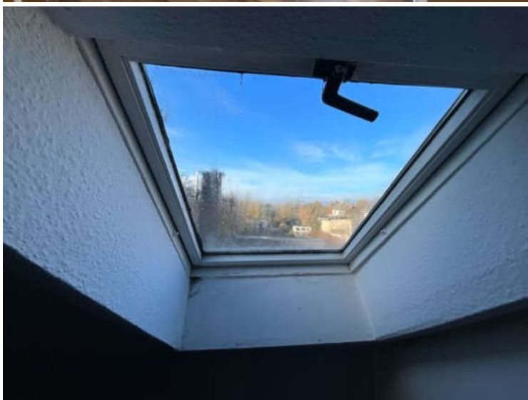
Bild 31: Wohnraum 2 (DG) mit Feuchte- und Substanzschäden im Fensterbereich
