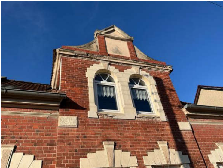
Bild 6: Feuchte- und Substanzschäden im Fassadenbereich
