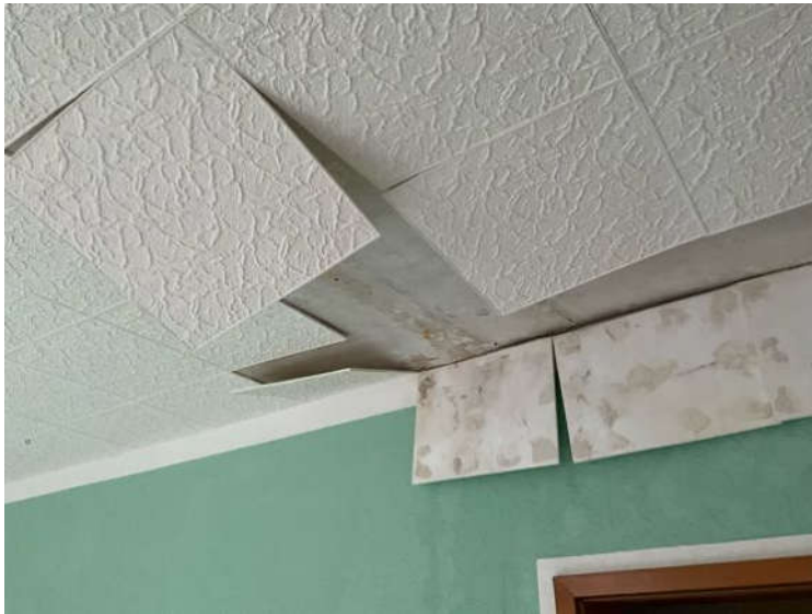
Bild 45: Wohnraum 1 (EG) mit Feuchte- und Substanzschäden im Deckenbereich
