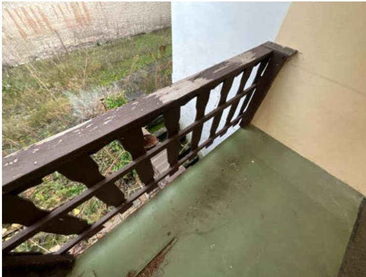
Bild 42: Feuchte- und Substanzschäden im Bereich der Terrasse
