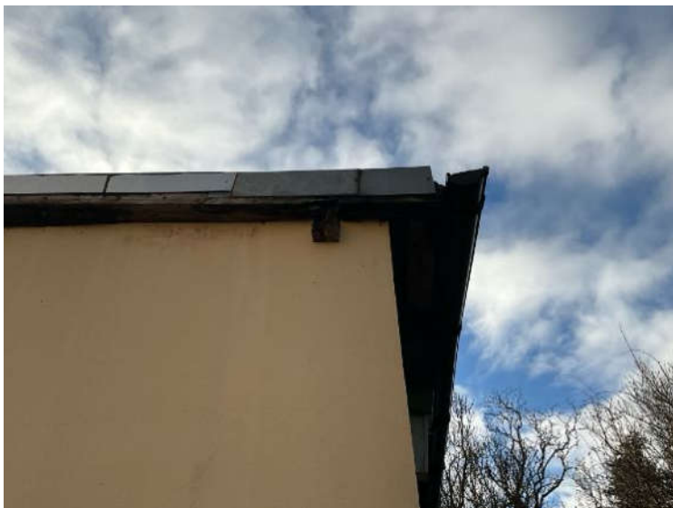
Bild 17: Feuchte- und Substanzschäden im Bereich des Pultdaches der Garage
