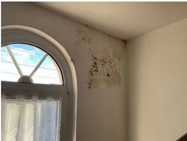
Bild 36: Wohnraum 3 (DG) mit Feuchte- und Sub- stanzschäden im Wand- und Fensterbereich
