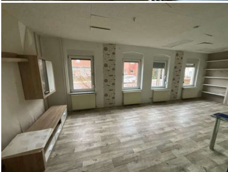
Bild 47: Wohnraum 1 (EG) mit Feuchte- und Substanzschäden im Deckenbereich
