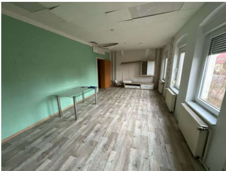
Bild 43: Wohnraum 1 (EG) mit Feuchte- und Substanzschäden im Deckenbereich
