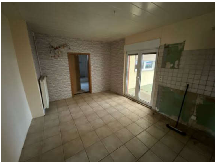
Bild 49: Küche (EG) mit Substanzschäden im Wandbereich
