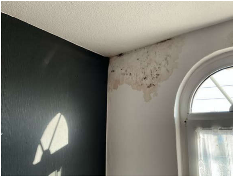
Bild 35: Wohnraum 3 (DG) mit Feuchte- und Sub- stanzschäden im Wand- und Fensterbereich
