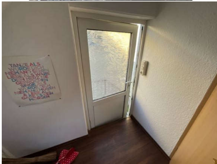
Bild 23: Flur (DG) mit mangelhaftem Wohnungszugang (Stufenausbildung / lichte Höhe)
