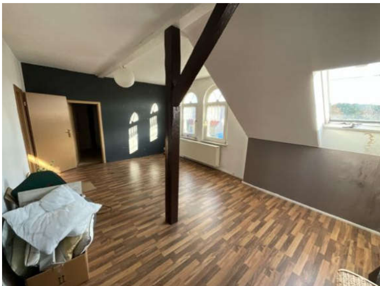
Bild 33: Wohnraum 3 (DG) mit Feuchte- und Sub- stanzschäden im Wand- und Fensterbereich
