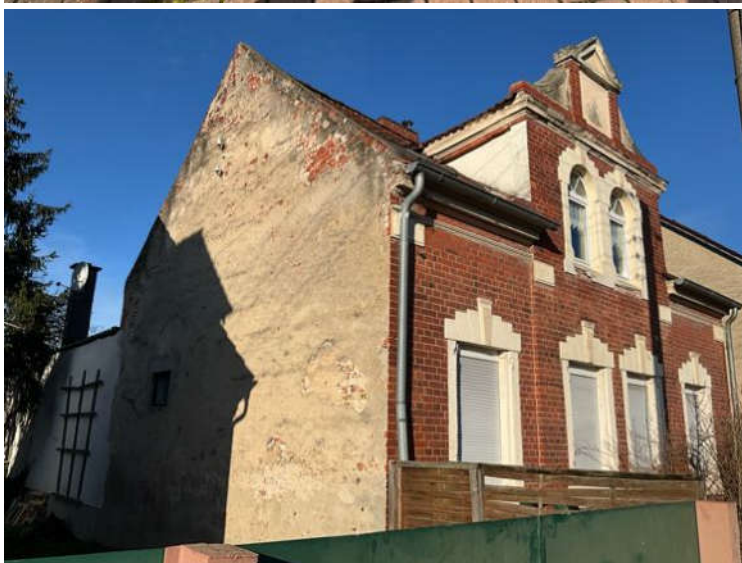
Bild 5: Feuchte- und Substanzschäden im Giebelbereich
