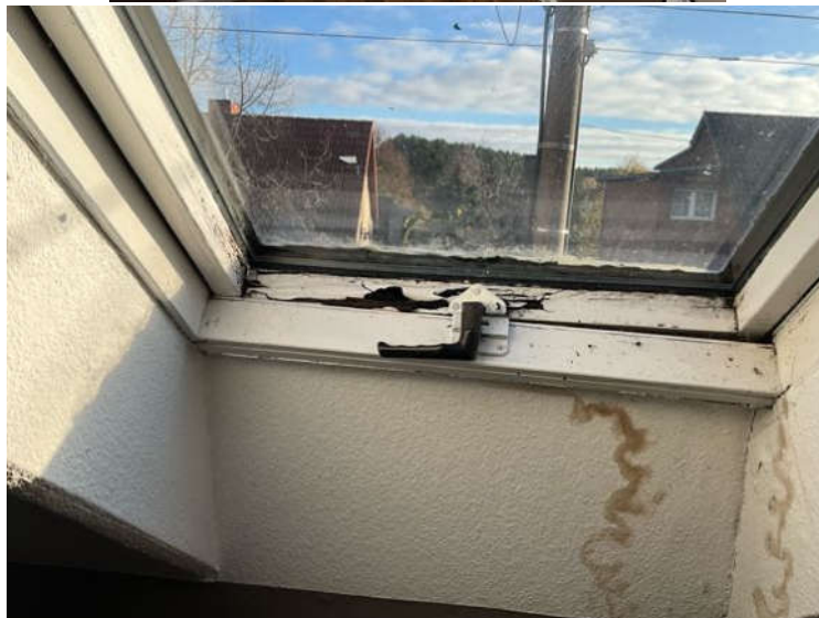
Bild 38: Wohnraum 3 (DG) mit Feuchte- und Sub- stanzschäden im Wand- und Fensterbereich
