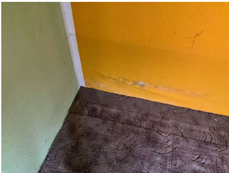
Bild 58: Wohnraum 3 mit Feuchte- und Substanz- schäden im Wandbereich (EG)
