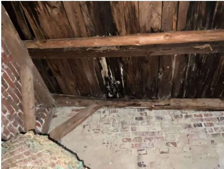
Bild 19: holzerstörender Pilzbefall im Dachbereich
