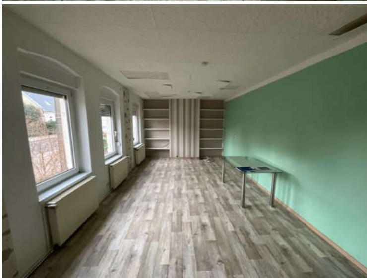
Bild 44: Wohnraum 1 (EG) mit Feuchte- und Substanzschäden im Deckenbereich
