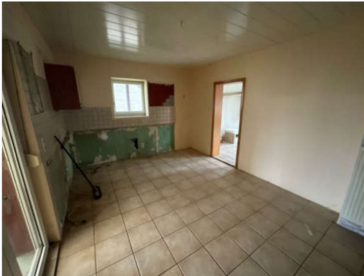
Bild 48: Küche (EG) mit Substanzschäden im Wandbereich
