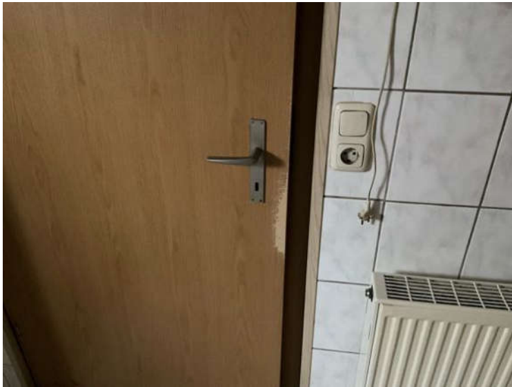
Bild 54: Substanzschäden an der Innentür
