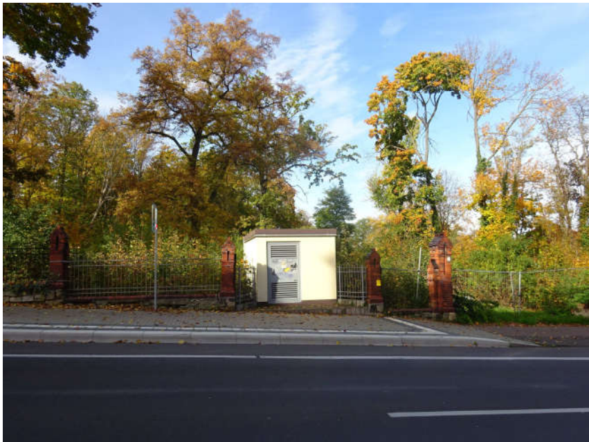
Bild 4: Trafo der Stadtwerke Weißenfels von der Naumburger Straße aus
