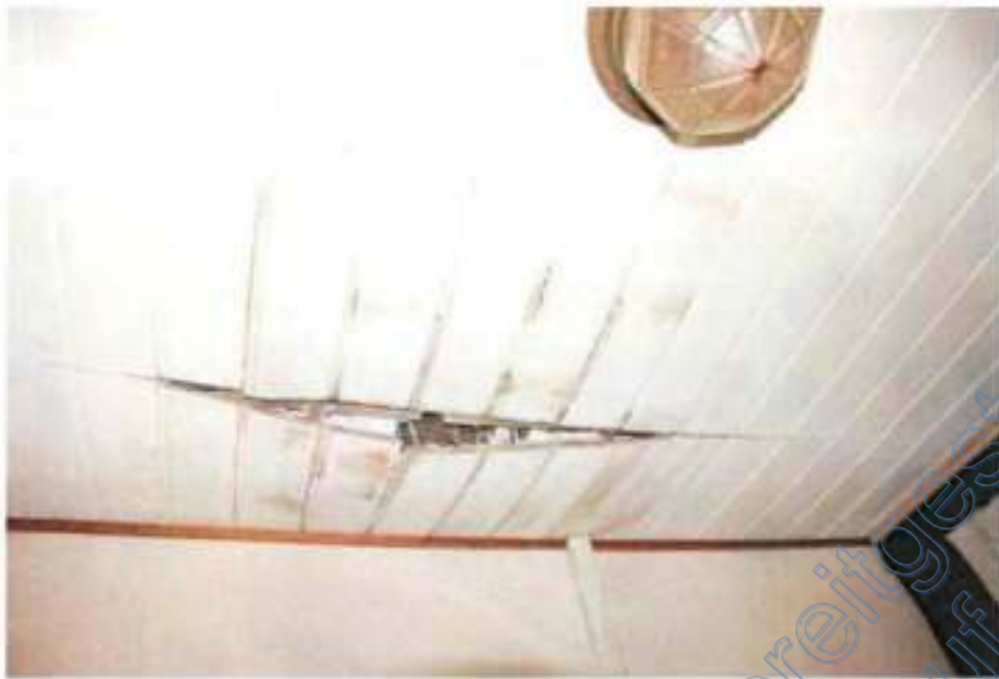
Foto 4 Feuchteschäden mit Pilzbildung an der Decke über der Diele im Erdgeschoss
