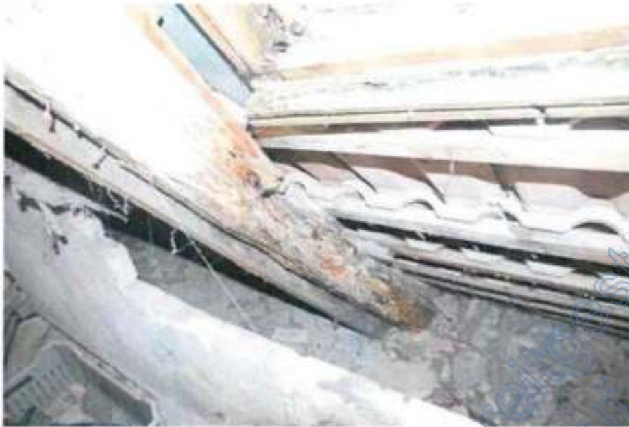
Foto 13 Feuchteschäden infolge undichter Dachfenster
