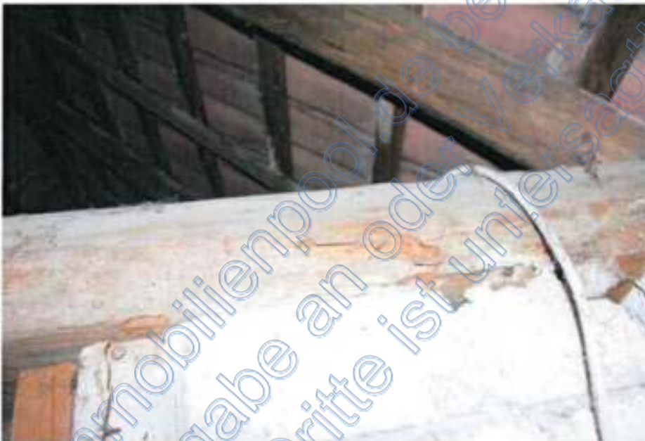
Foto 14 Dachstuhl mit Spuren von Anobienbefall
