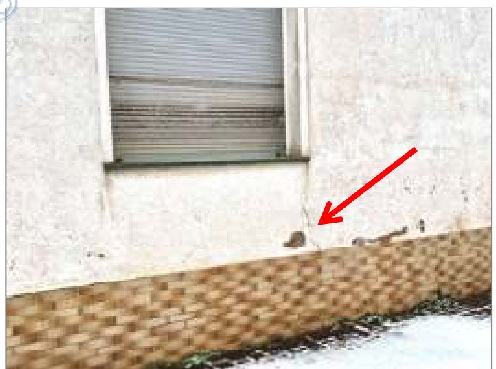
Putzschäden und Rissbildungen am Südwestgiebel
