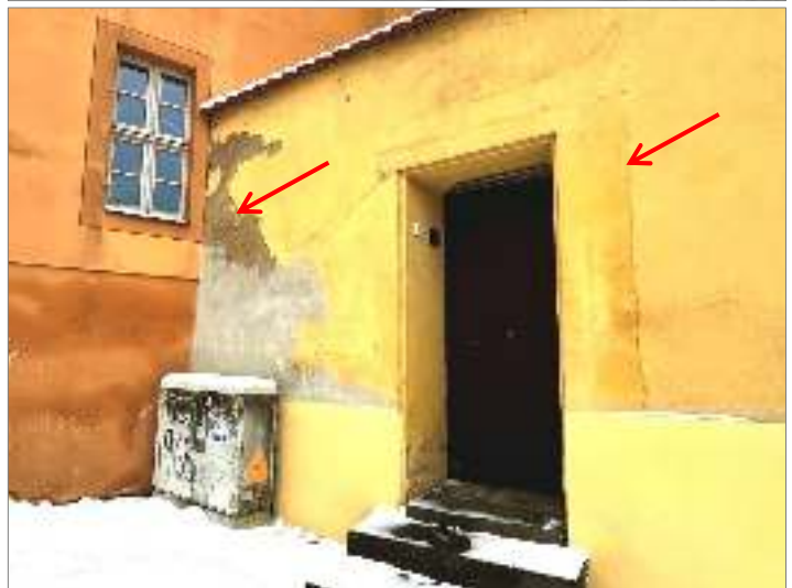
Umfassungen mit Feuchtigkeitsschäden und Putzrissen
