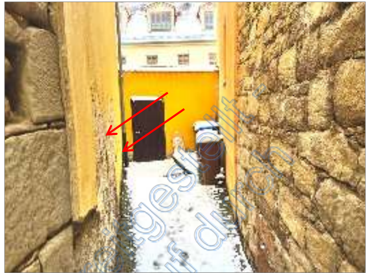
Durchgang zur Straße; auch hier Feuchtigkeits- und Putzschäden
