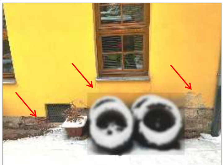
Fassadensockel mit Feuchtigkeits-, Putz- und Mauerwerksschäden
