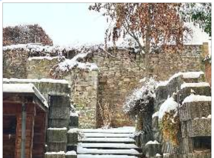
Steingarten – unfachmännisch hergestellt und Gefahrenquelle; stark schadhafte Einfriedungsmauer
