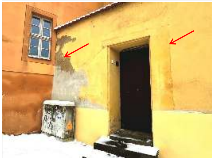
Umfassungen mit Feuchtigkeitsschäden und Putzrissen
