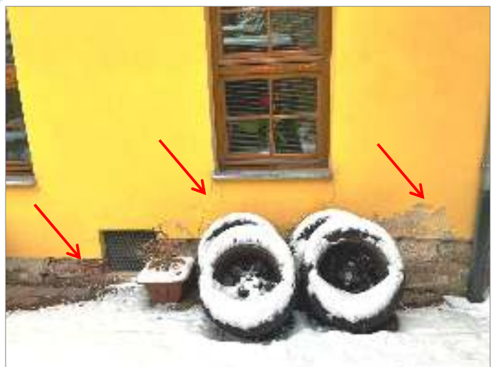
Fassadensockel mit Feuchtigkeits-, Putz- und Mauerwerksschäden
