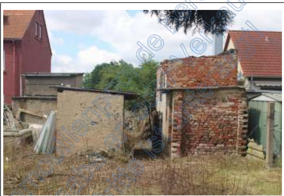
Ansicht vom abbruchreifen Schuppengebäude
