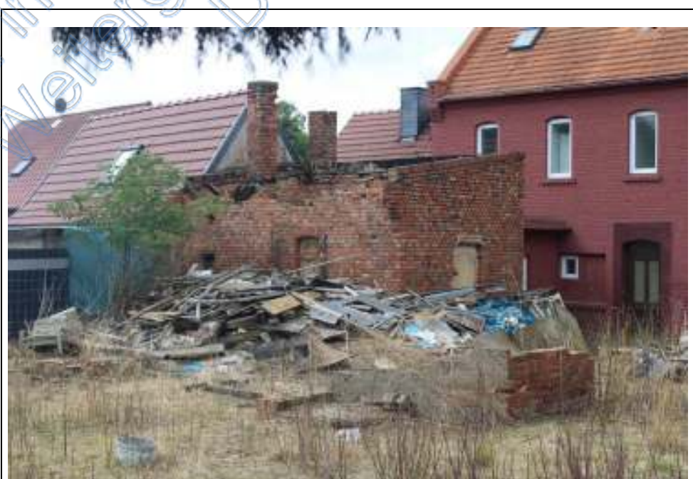
Ansicht vom abbruchreifen Schuppengebäude
