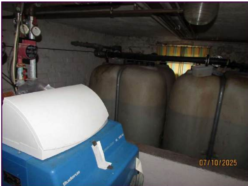
Abbildung 3: Heizraum mit Öltanks im KG.
