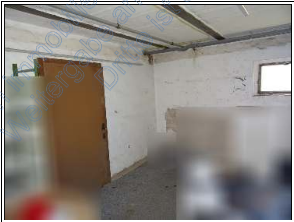
Foto 10: BV Nr. 1 : beispielhafter Lagerraum im KG des EFH
