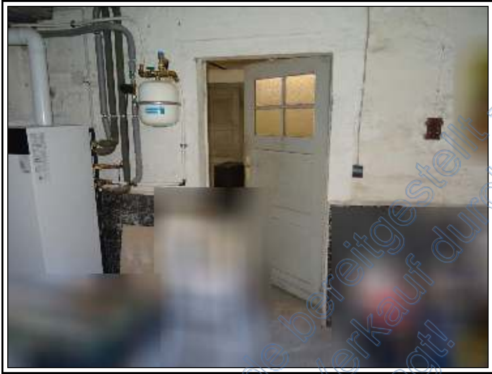
Foto 9: BV Nr. 1 : Heizungsraum im KG des EFH
