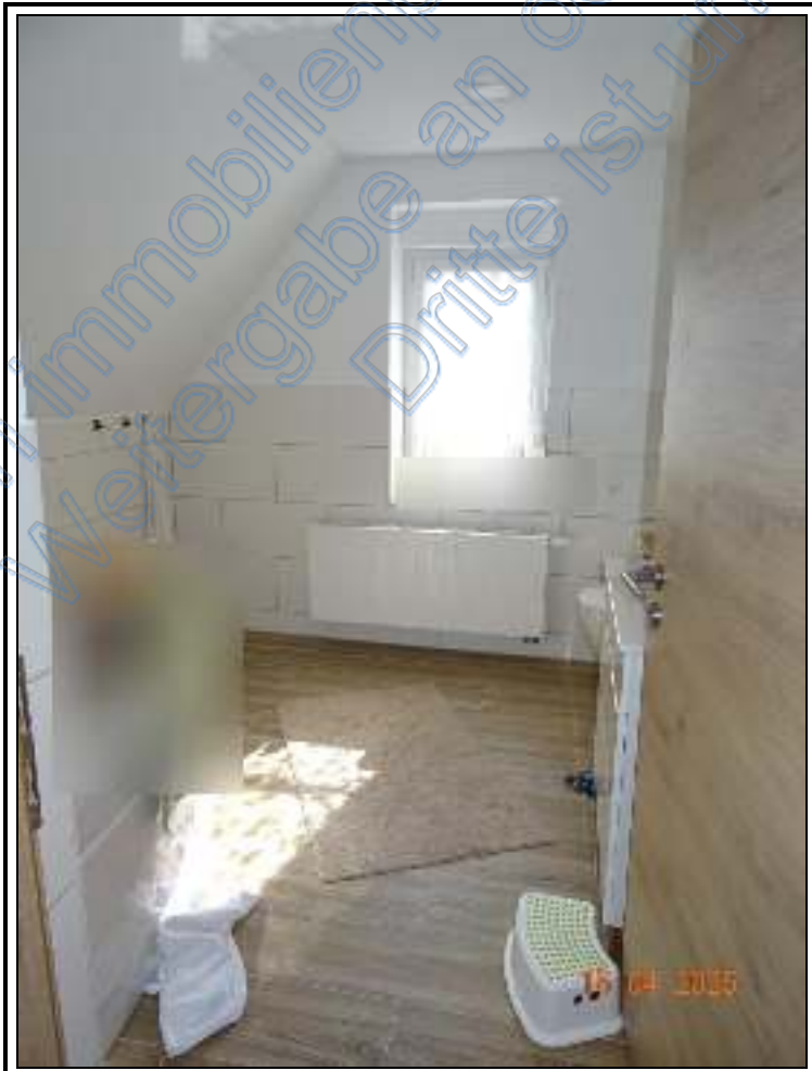
Foto 22: BV Nr. 1 : Wannenbad mit WC im DG des EFH
