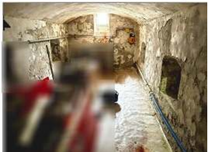
Teilkeller mit massiven Feuchtigkeitsschäden
