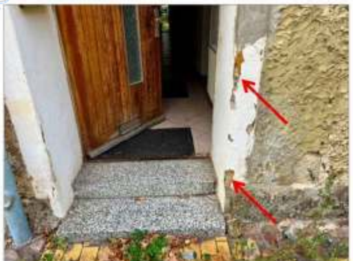
Fassadenschäden; Hauseingang mit Putzabplatzungen
