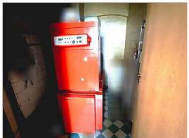
Heizungsanlage im EG des Wohnhauses
