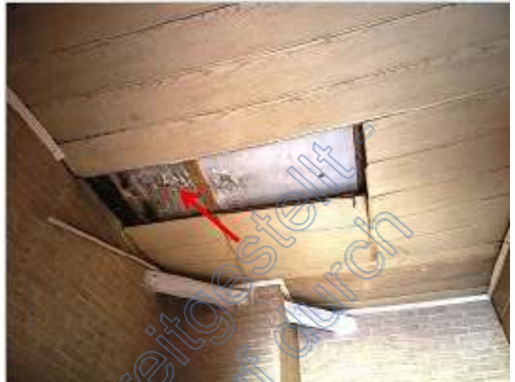
Feuchtigkeitsschaden an der EG-Decke – im Heizungsraum
