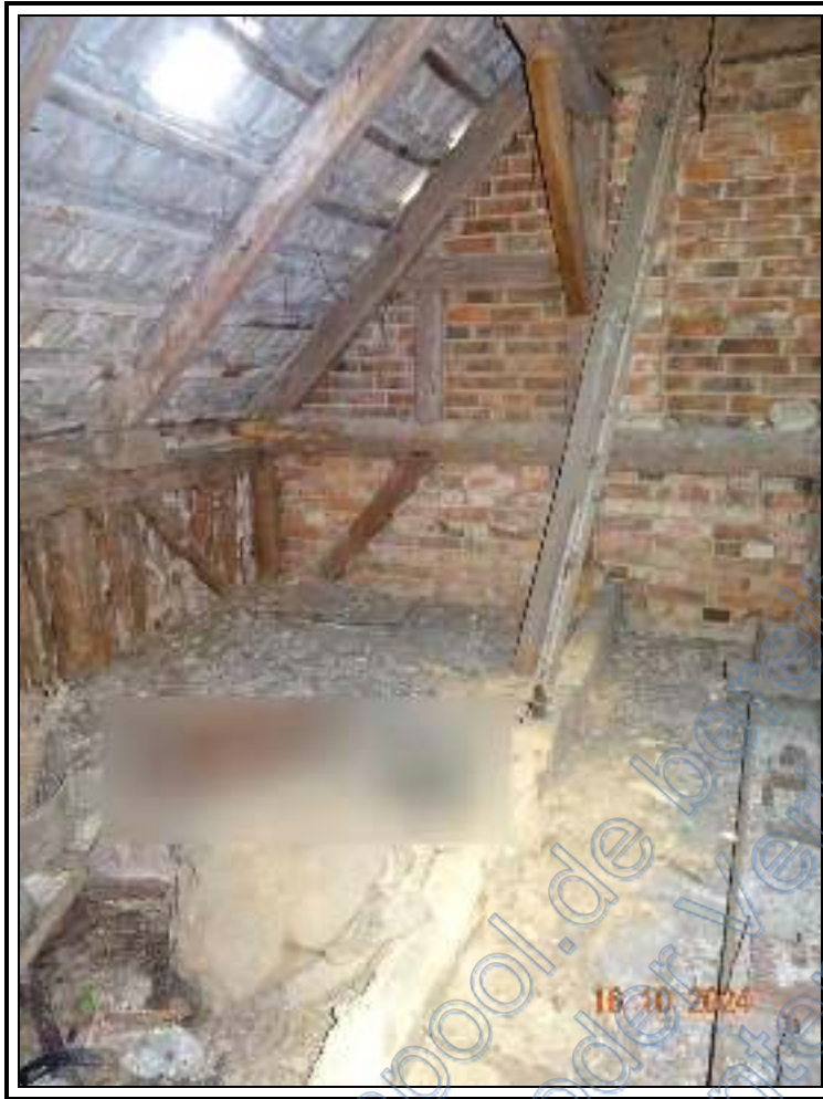
Foto 17: BV Nr. 1 : Dachboden des ehemaligen Wohnhauses mit schadhaftem Balken
