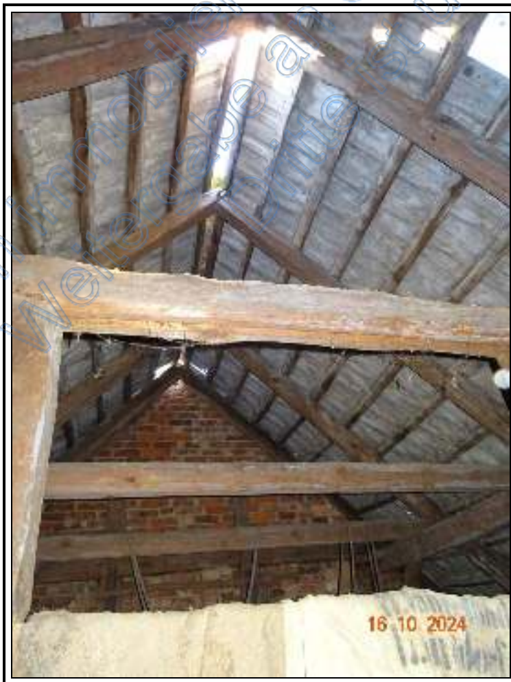
Foto 18: BV Nr. 1 : Dachboden des ehemaligen Wohnhauses mit schadhafter Dachhaut
