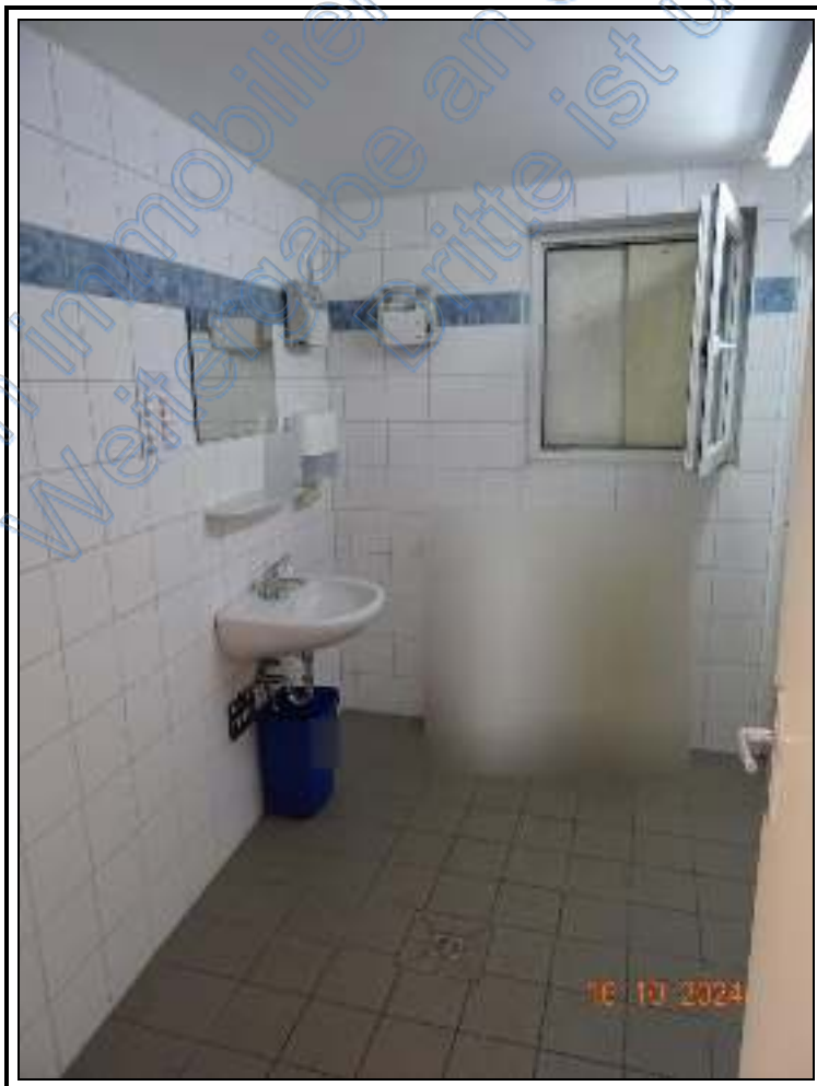
Foto 24: BV Nr. 1 : WC-Frauen im EG des ehemaligen Wirtschaftsgebäudes
