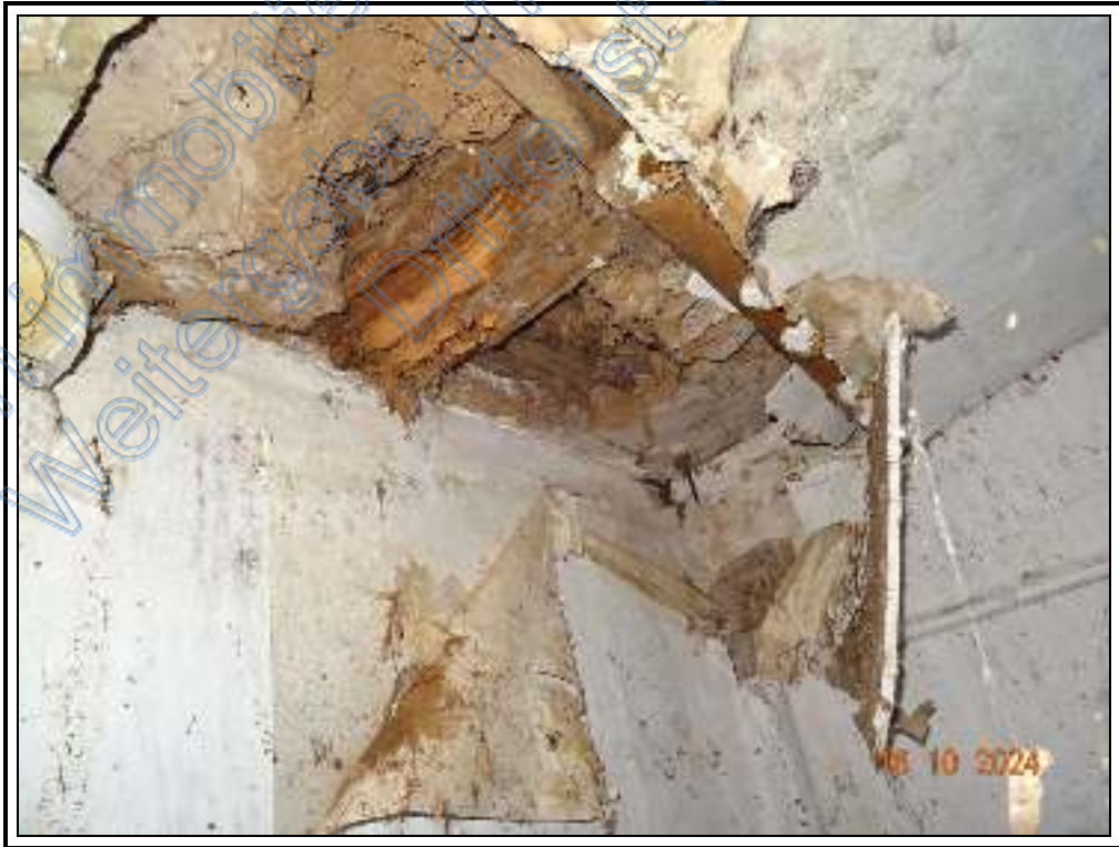
Foto 14: BV Nr. 1 : schadhafter Deckenbalken im EG des ehemaligen Wohnhauses
