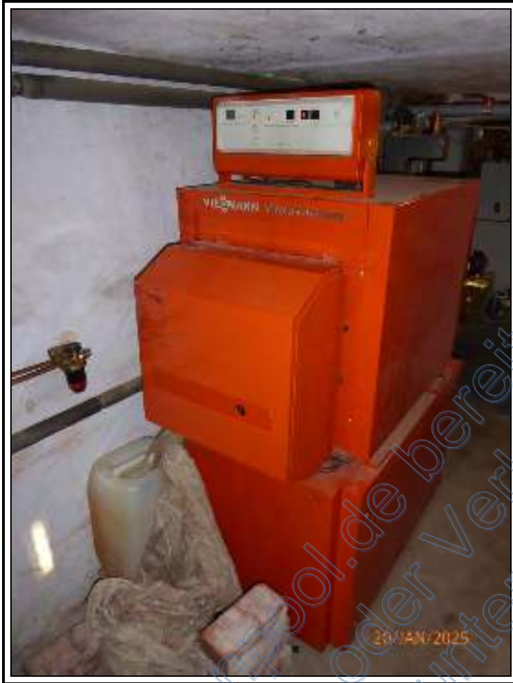
Foto 9: Heizungsanlage im KG des Wohngebäudes
