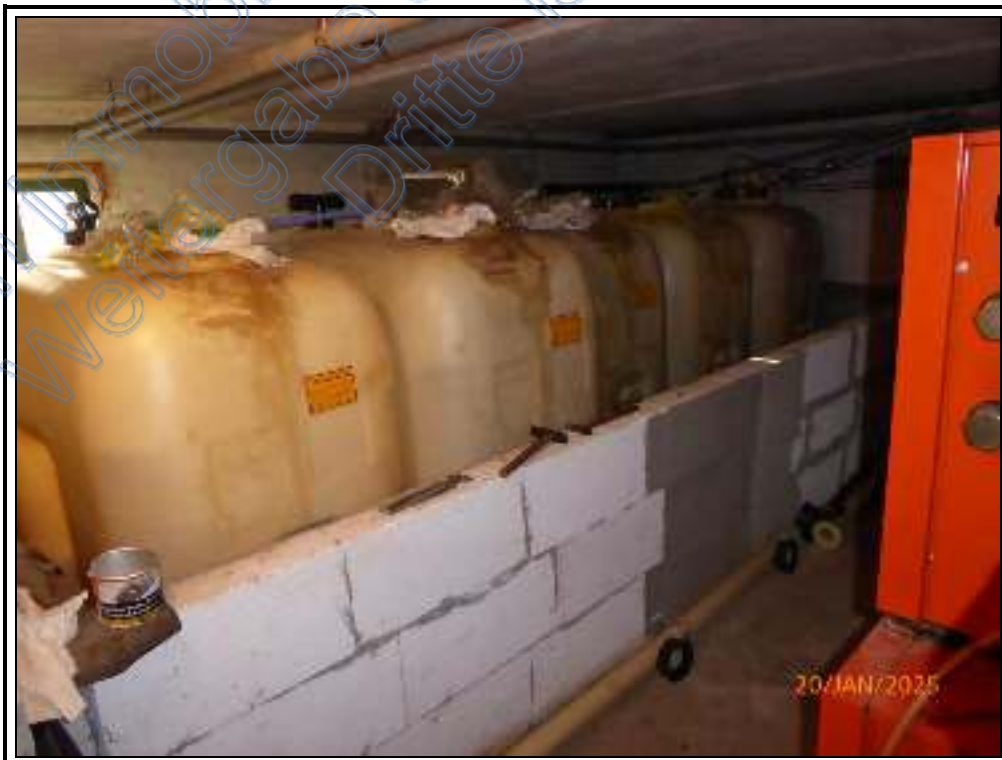
Foto 10: Öltanklager im KG des Wohngebäudes
