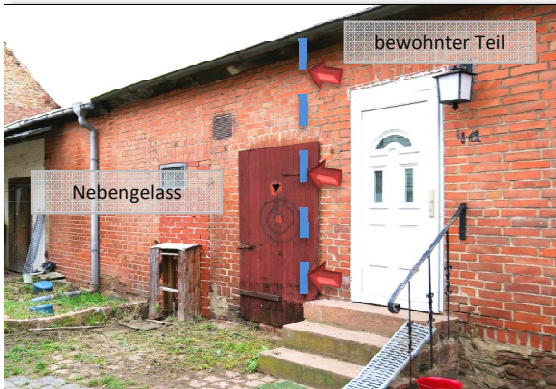
BILD A1: keine Wärmedämmung an der Klinkerwand Wohneinheit 4 A
