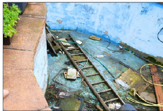
BILD A6: Müll-Ablagerungen und defekter Farbanstrich im Pool
