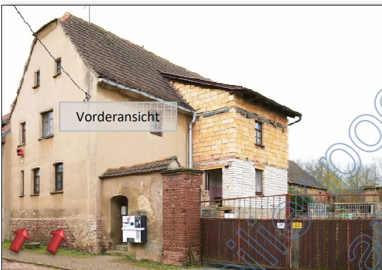
BILD A3: Nässeschaden am Sockel, kein Putz und Wärmedämmung auf Anbau Wohneinheit 4 C (Vorderansicht)
