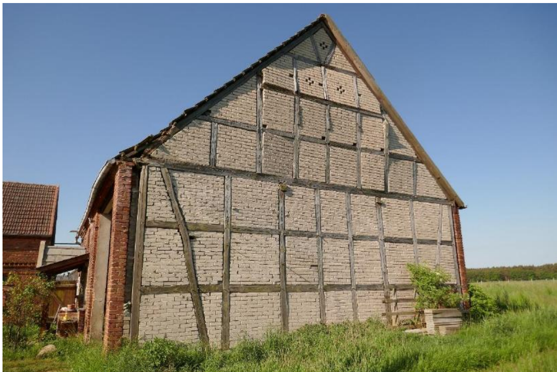
Foto 8, Nordgiebelwand ehemalige Scheune (Geb. 3) mit nach innen und nach außen verschobenen Gefache sowie nach innen und außen abgekippter Gefachausmauerung, Nordansicht
