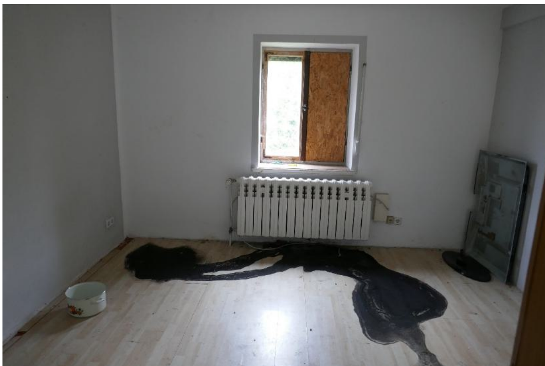
Foto 12, EG ein Wohnraum, Heizungswasser aus dem Gussradiator ausgelaufen, vermutlich Frostschaden
