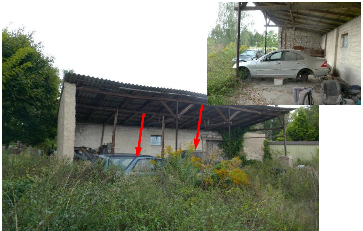
Foto 10, Unterstand (Geb. 2), schlechter baulicher Zustand, kein Zeit-/Marktwert, Pfeile weisen zu fahruntüchtigen Pkw, Südostansicht
