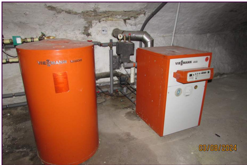
Abbildung 8: Heizkontrollraum in der Teilunterkellerung.
