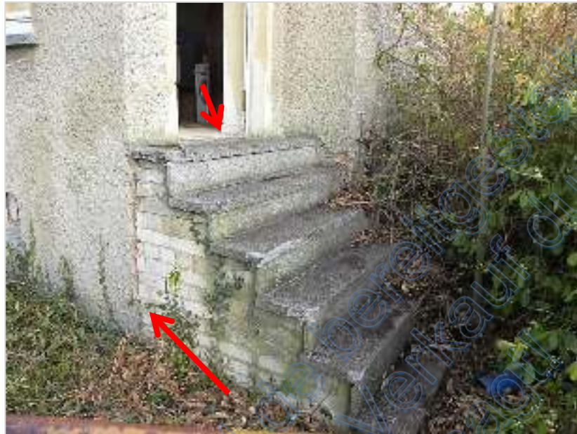
Bild 3 – Zustand des Eingangsbereiches zu Windfang Nr.1.a
