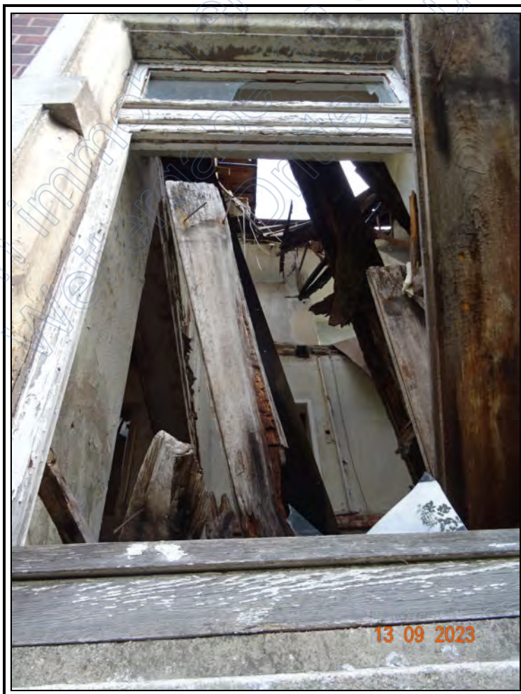
Foto 30: eingestürzte Decken und Dach im Torhaus
