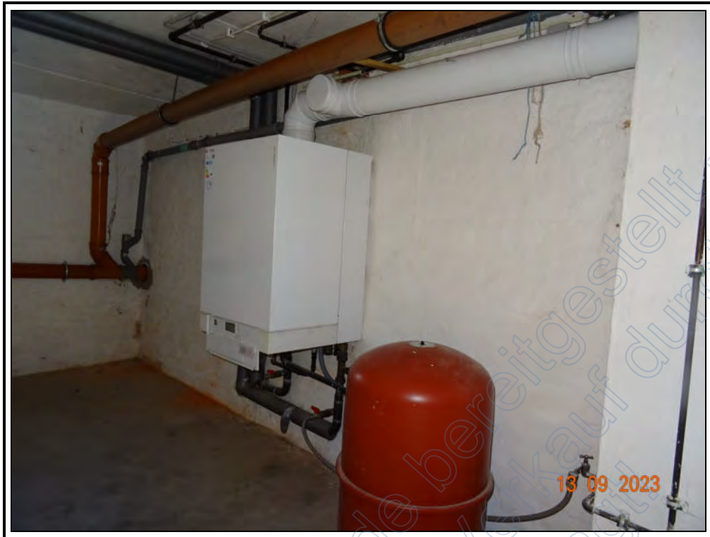
Foto 13: Heizungsraum im KG des Mehrfamiliendoppelhauses
