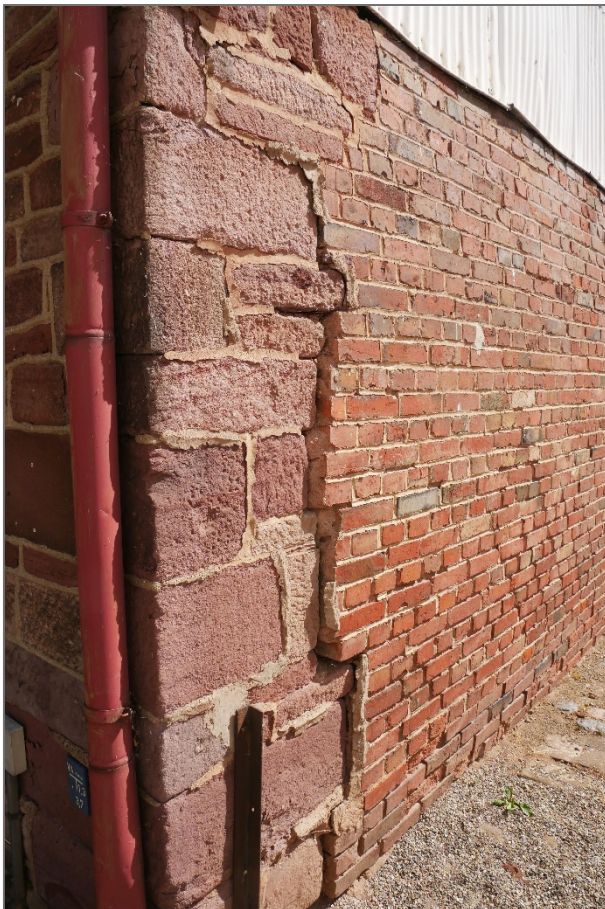
Wohnhaus - südseitige Außenwand im EG mit Verschiebungen / Ausbauchungen
