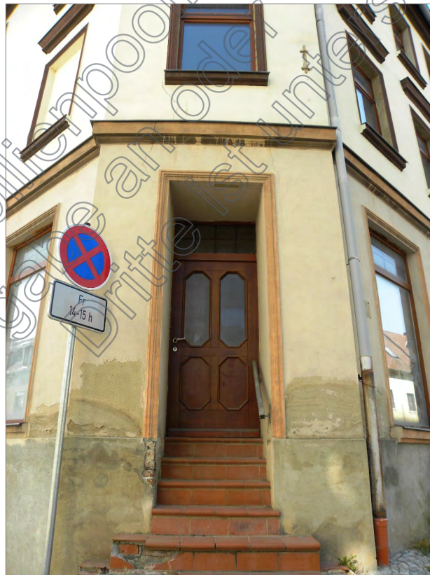
Haupteingang mit schadhafter Treppenanlage, Feuchtigkeitsschäden und Ausblühungen an der Fassade sowie Rissbildungen im Erdgeschoss- Friesbereich
