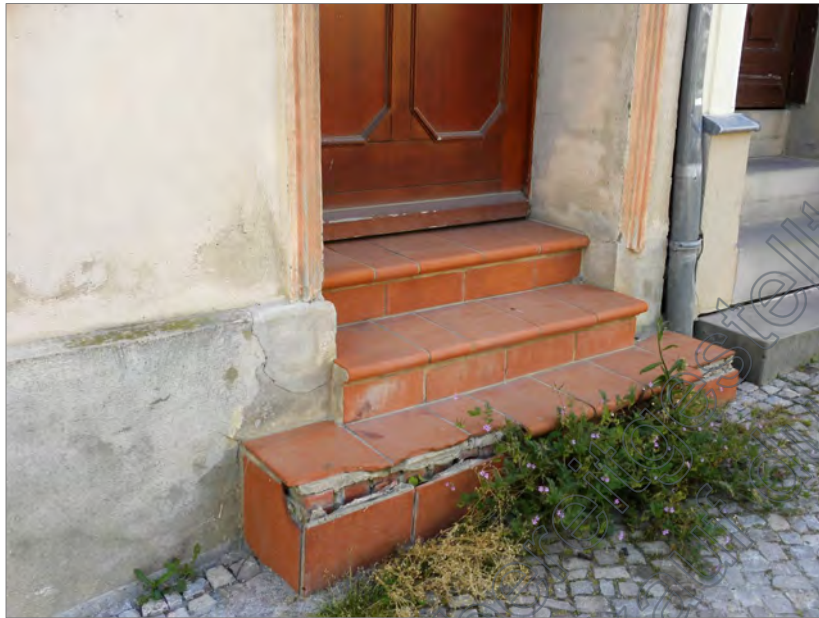
Treppenanlage Nebeneingang schadhaft
