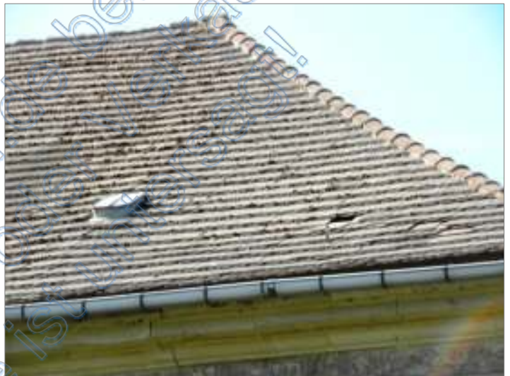
Dacheindeckung im mangelhaften Zustand
