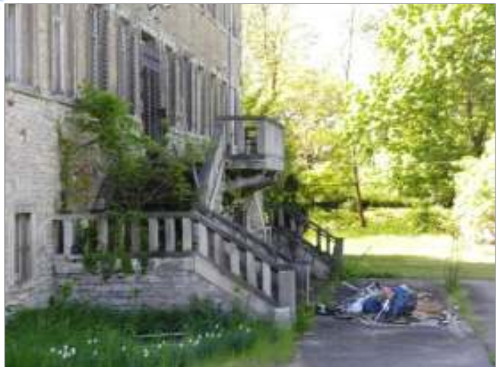
Haupteingang mit Treppenanlage im mangelhaften Zustand
