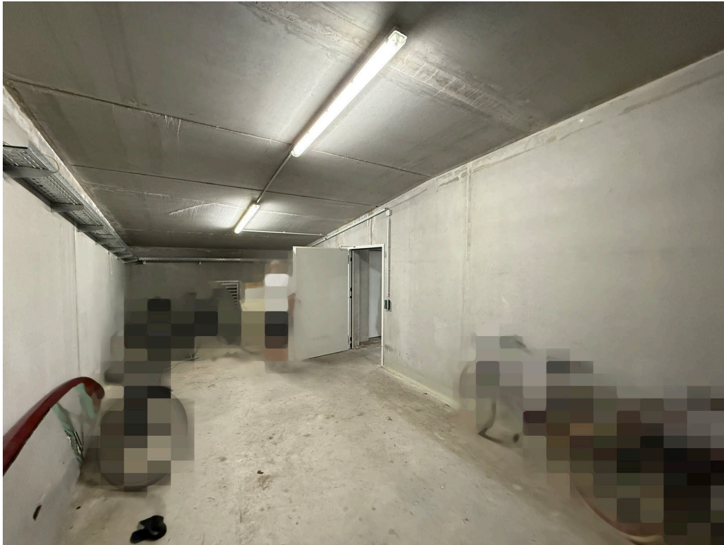
Fahrradabstellraum unter der Tiefgaragenzufahrt (Gemeinschaftseigentum)
