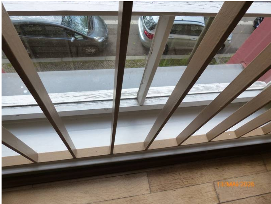
Fotos 37 und 38: Farbabplatzungen an den Treppenhausfenstern
