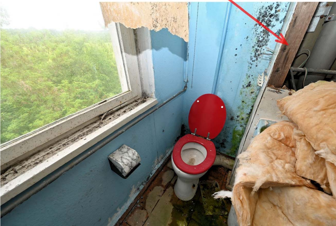
Abb. 48: SE Nr. ⑭, Bad/WC, starker Wasserschaden (wohl Trinkwasserleitung)
