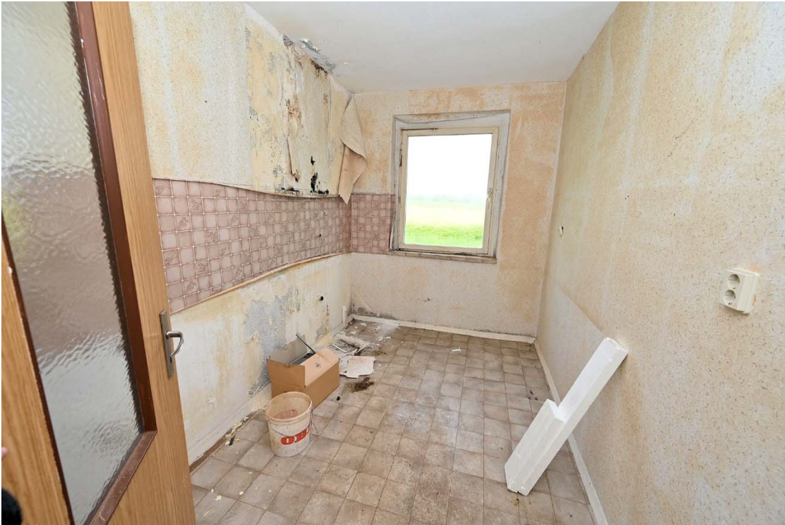
Abb. 19: SE Nr. ②, Wohnraum, Küche (links Wasserschaden aus dem Bad)
