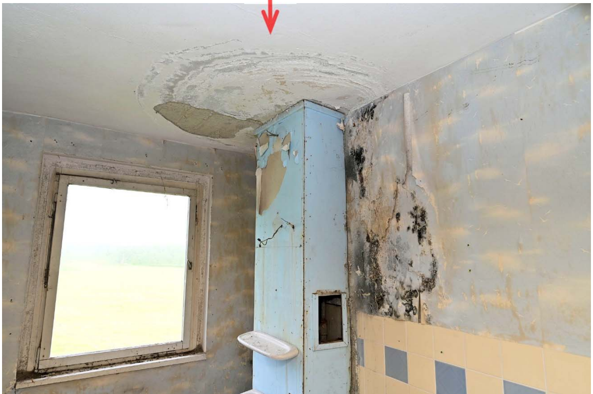
Abb. 34: SE Nr. ⑥, Bad/WC, Detail Wasserschaden (wohl Trinkwasserleitung)
