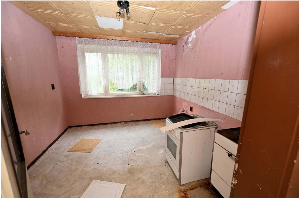
Abb. 41: SE Nr. ⑨, Küche (rechts Wasserschaden aus dem Bad)
