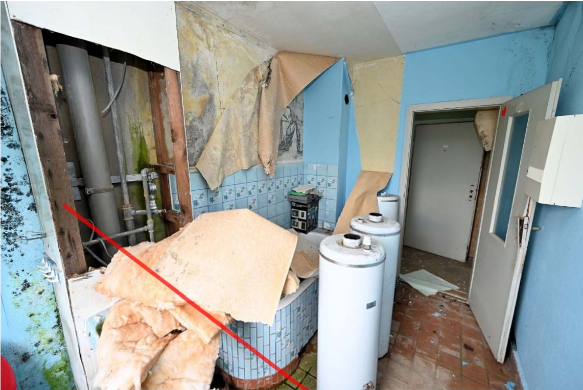
Abb. 47: SE Nr. ⑭, Bad/WC, starker Wasserschaden (wohl Trinkwasserleitung)
