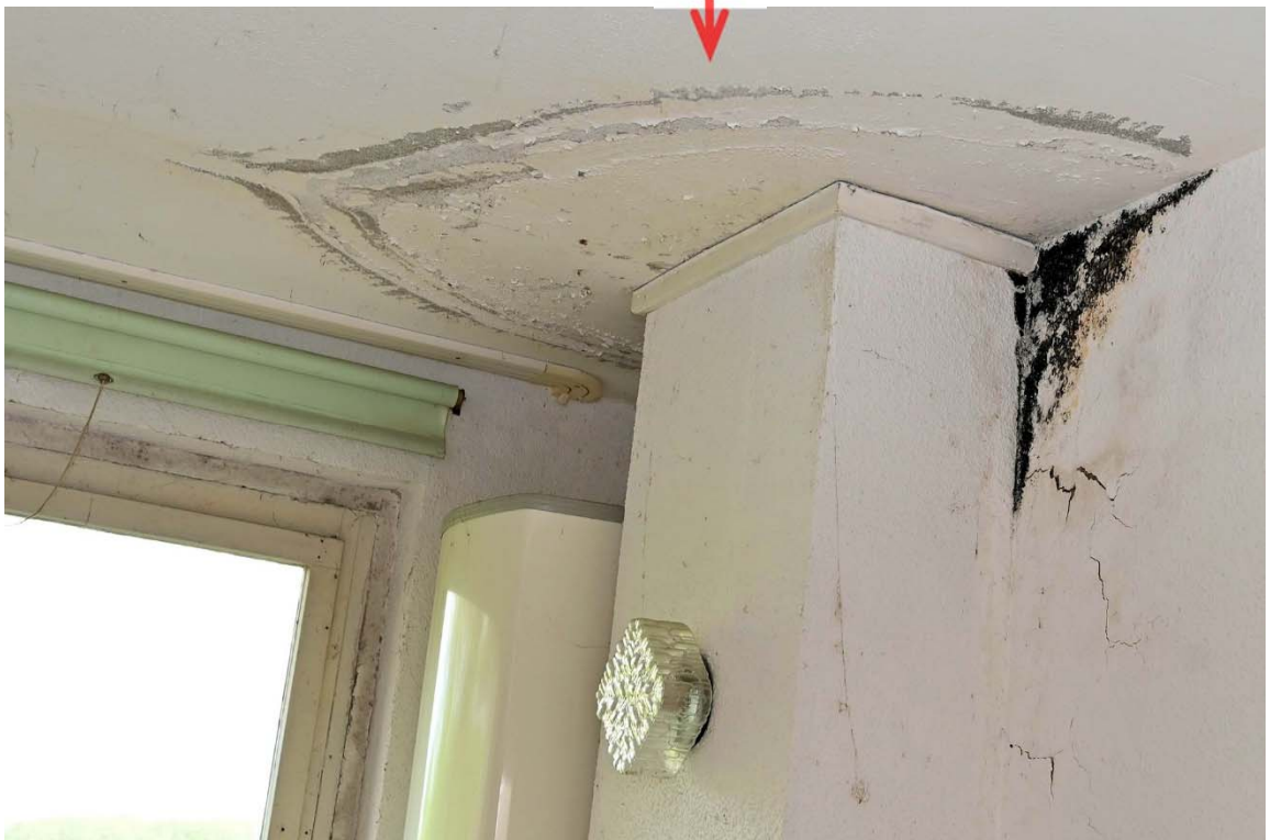
Abb. 18: SE Nr. ②, Wohnraum, Bad/WC, Detail Wasserschaden (wohl Trinkwasserleitung)
