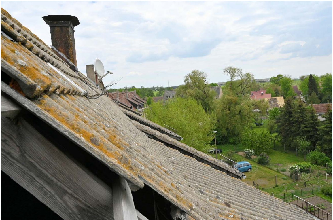
Abb. 57: Dachspitz im Bereich des westlichen Giebels, (fehlende) Dacheindeckung / Ausblick Richtung Kirchgasse 7 / 8
