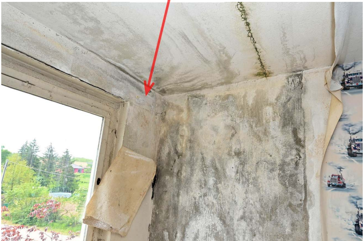
Abb. 30: SE Nr. ⑤, Wohnraum nach Süden am Giebel, Detail Einregnungsschäden
