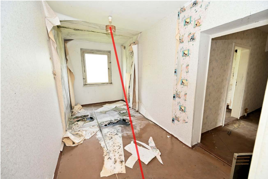
Abb. 27: SE Nr. ⑤, Wohnraum nach Norden am Giebel (unterhalb Dachschaden)
