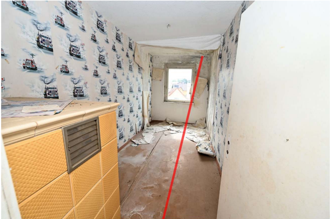
Abb. 29: SE Nr. ⑤, Wohnraum nach Süden am Giebel (unterhalb Dachschaden)
