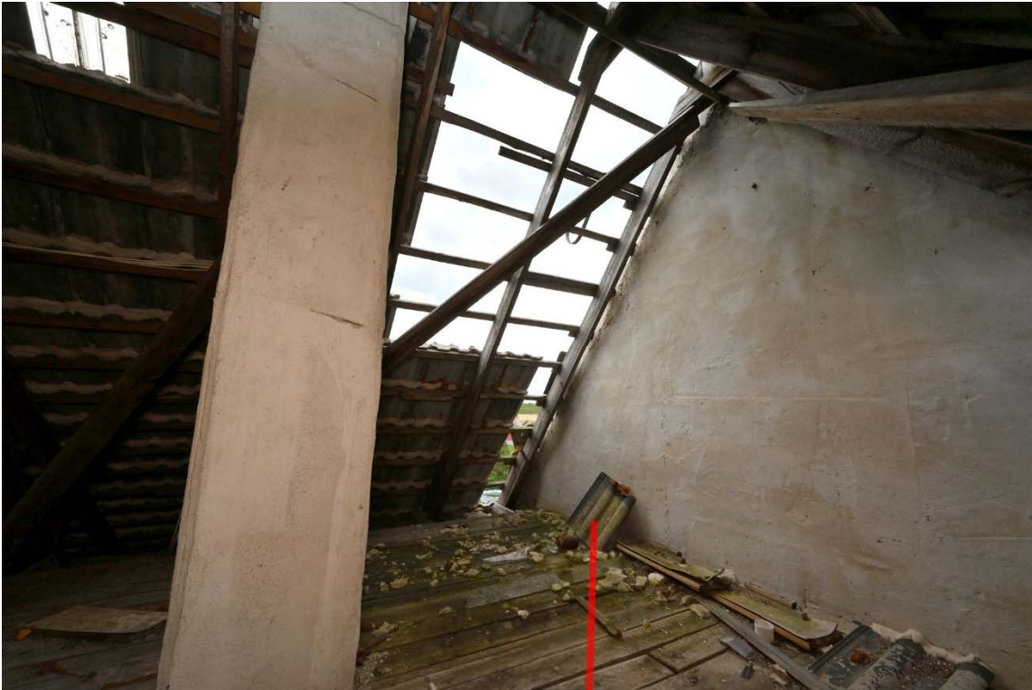
Abb. 55: Dachspitz im Bereich des westlichen Giebels, fehlende Dacheindeckung / Einregnung
