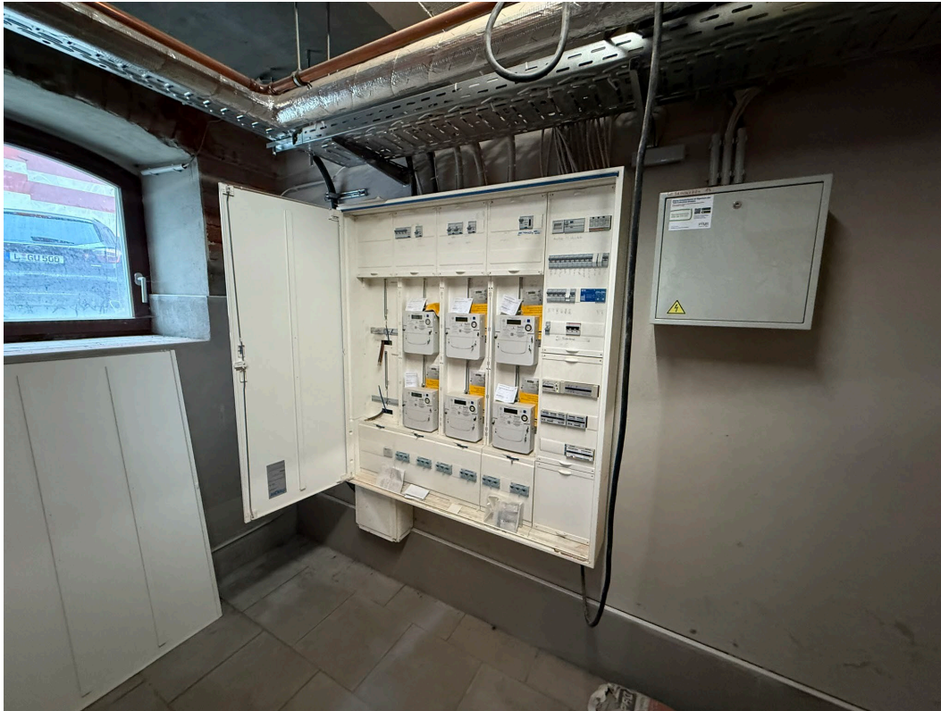
Zählerschrank im Kellergeschoss (Gemeinschaftseigentum)
