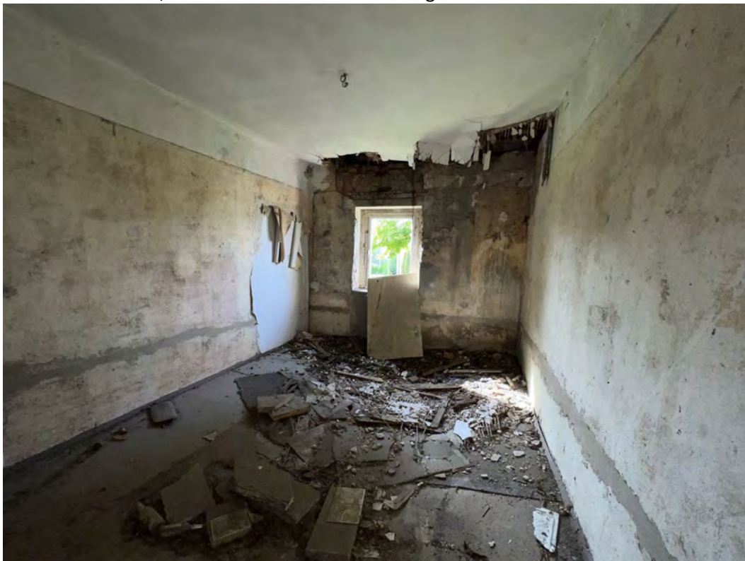
ehem. Herrenhaus; Raum im Obergeschoss mit durchgebrochener Decke
