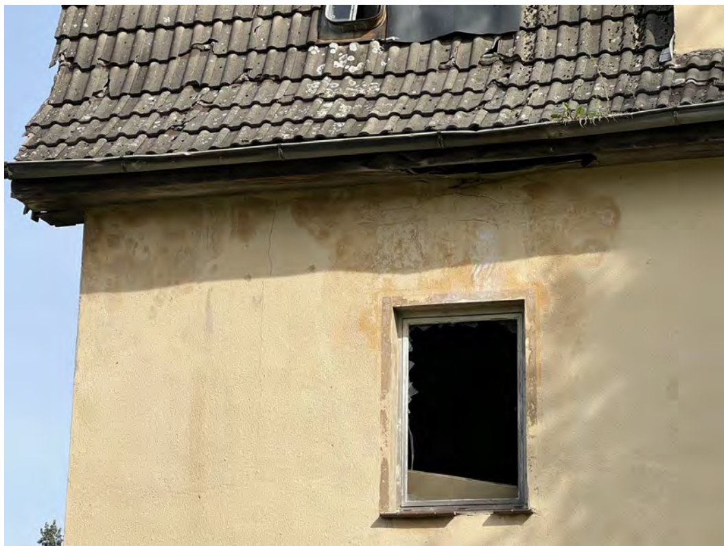
durchnässte Wandbereiche infolge jahrelangen Eindringens von Niederschlagswasser
