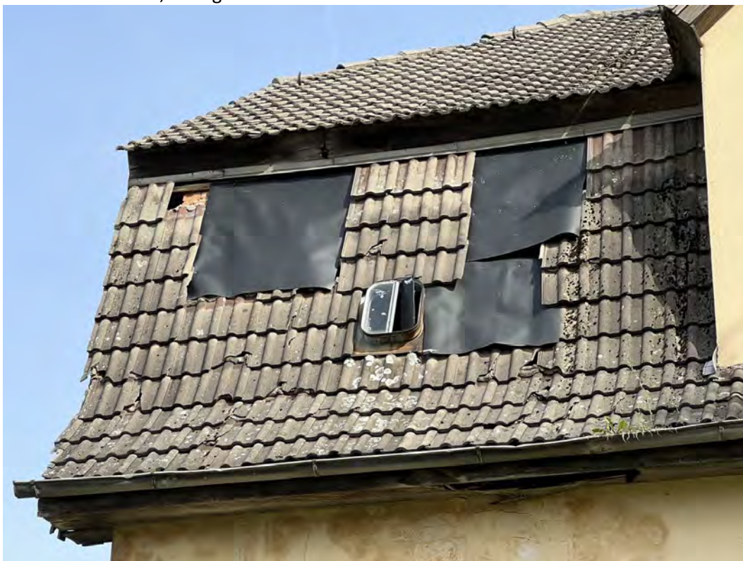
notdürftig reparierte Fehlstellen im Dach
