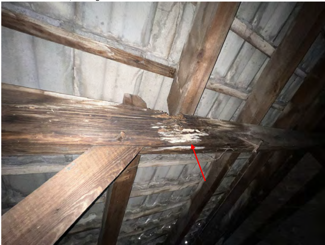
ehem. Herrenhaus; morsche/fast durchgefaltete Kehlbalken im Dachgeschoss
