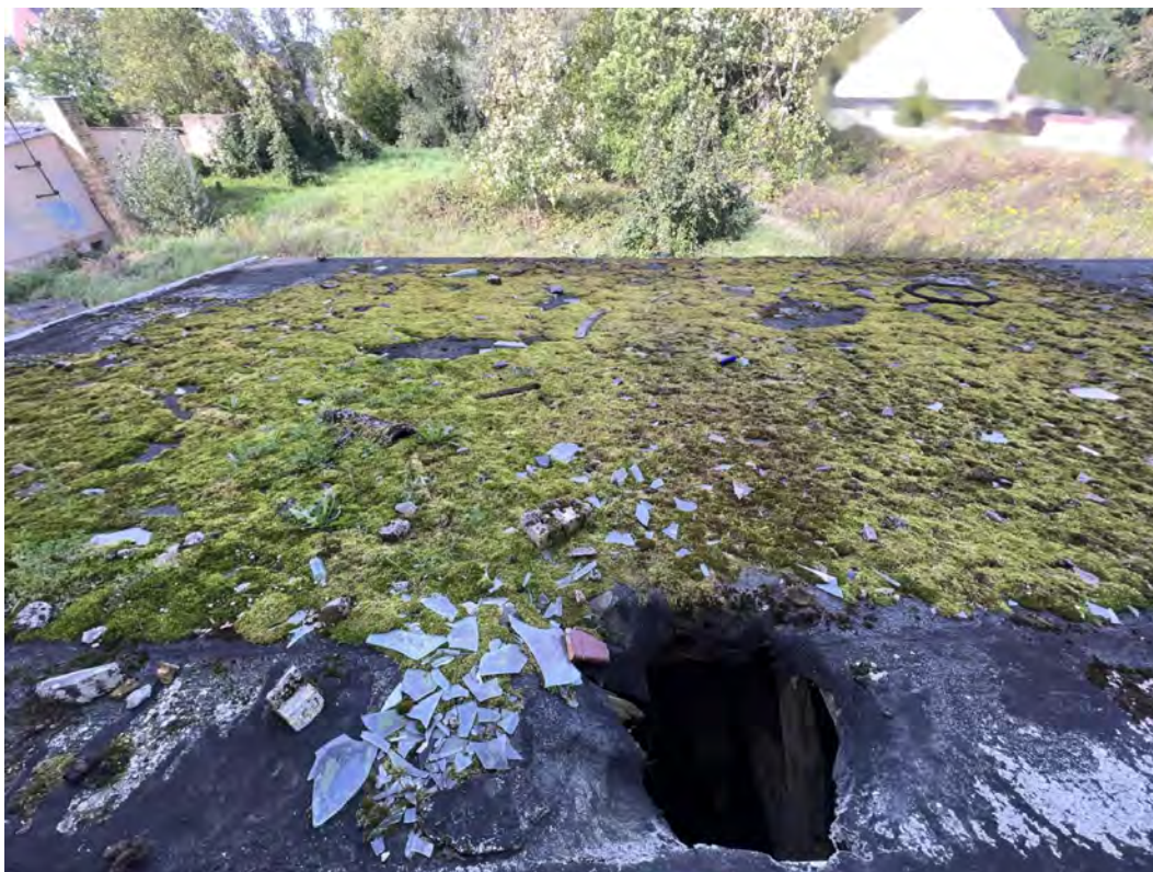
bereits durchgebrochenes Dach des Anbaus an das Herrenhaus
