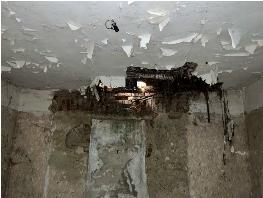
ehem. Herrenhaus; durchgebrochene Decke in einem anderen Raum
