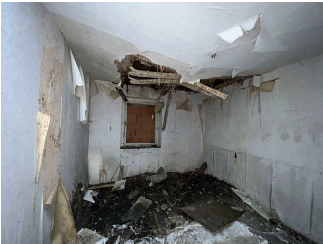
ehem. Herrenhaus; Raum im Erdgeschoss mit durchgebrochener Decke
