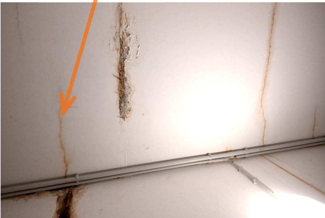
Abb. 16: Gemeinschaftseigentum, südliche Schleuse von der Tiefgarage zu Haus 1, Detail Einregnungsschäden
