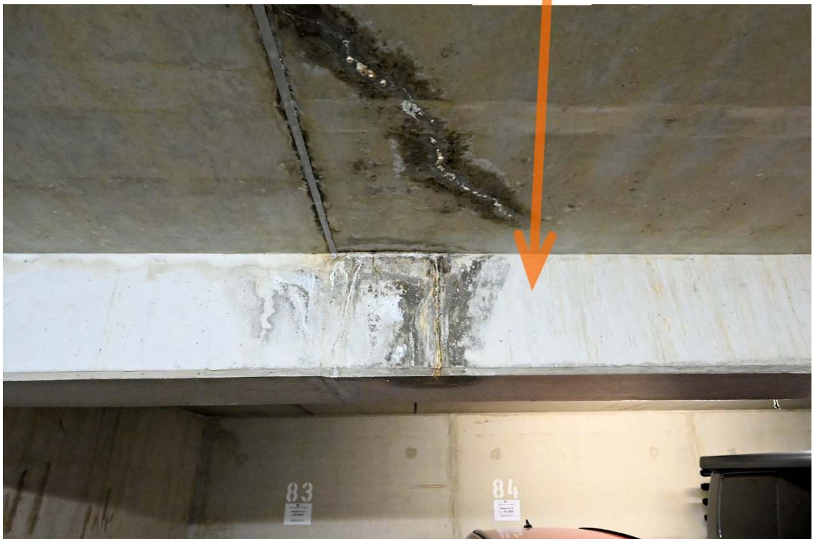
Abb. 14: Gemeinschaftseigentum, Tiefgarage, Detail Einregnungsschäden
