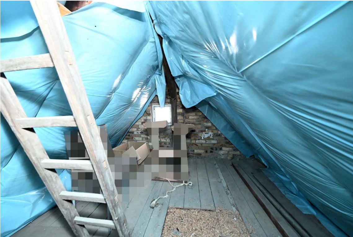
Abb. 35: Wohnhaus (A), Dachspitz, Zwischensparrendämmung ohne Unterlattung / ausbauchend
