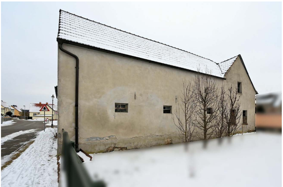
Abb. 2: Fassade Nebengebäude vonseiten des Nachbarn, Dachentwässerung zum Nachbarn
