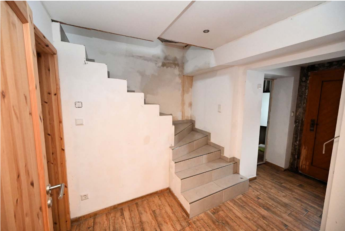
Abb. 19: Wohnhaus (A), Erdgeschoss, Flur, massive Nässeschäden infolge Frostscha-den Trinkwasserleitung im DG
