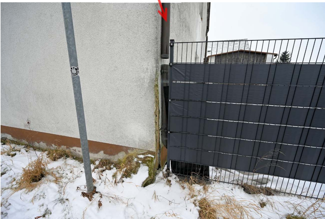
Abb. 4: Gebäudeansicht aus dem Gartenweg, Detail Gebäudeecke mit Nässeschäden
