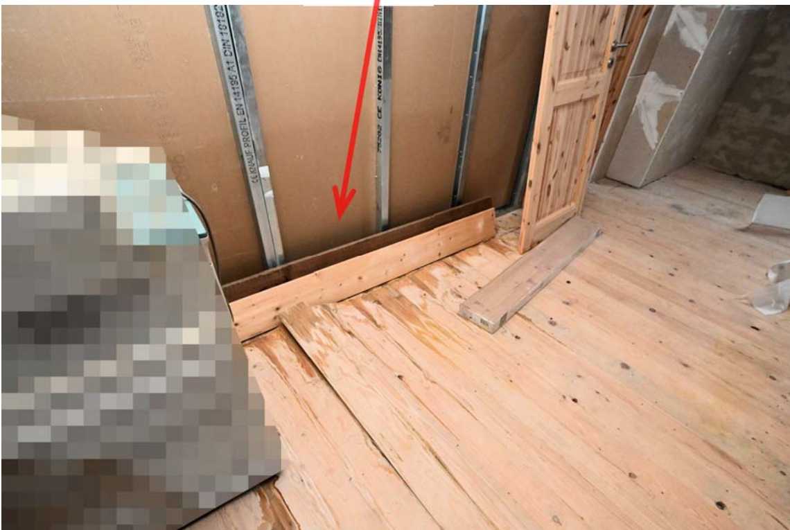
Abb. 32: Wohnhaus (A), Dachgeschoss, östliches Zimmer, Fußboden / Trennwand zum Flur mit starken Nässeschäden (Frostschaden Trinkwasserleitung)
