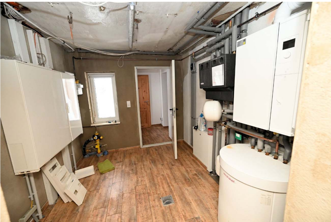
Abb. 12: Wohnhaus (A), Erdgeschoss, Hausanschluss-/ Heizungsraum
