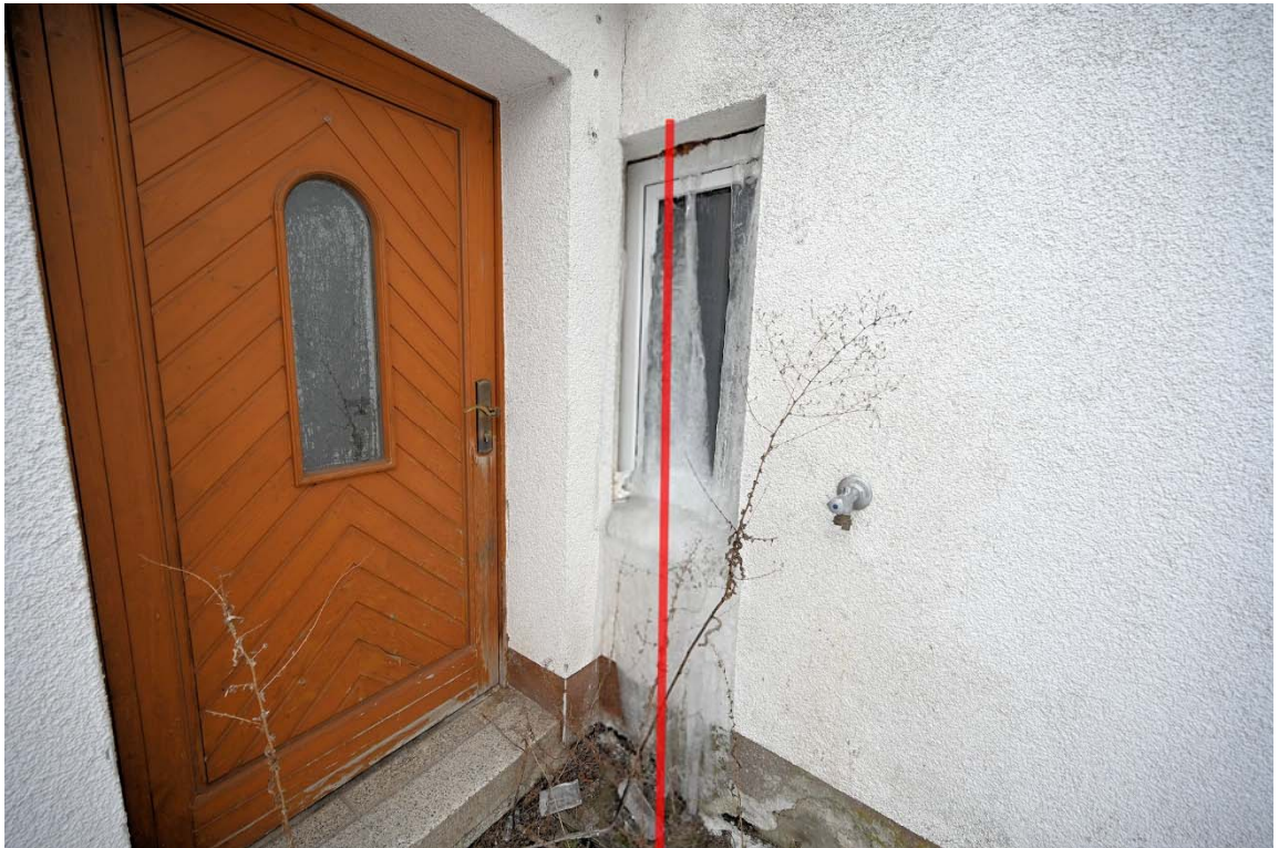
Abb. 9: Hauseingangstür und Fenster mit gefrorenem Wasser infolge Frostscha den Trinkwasserleitung
