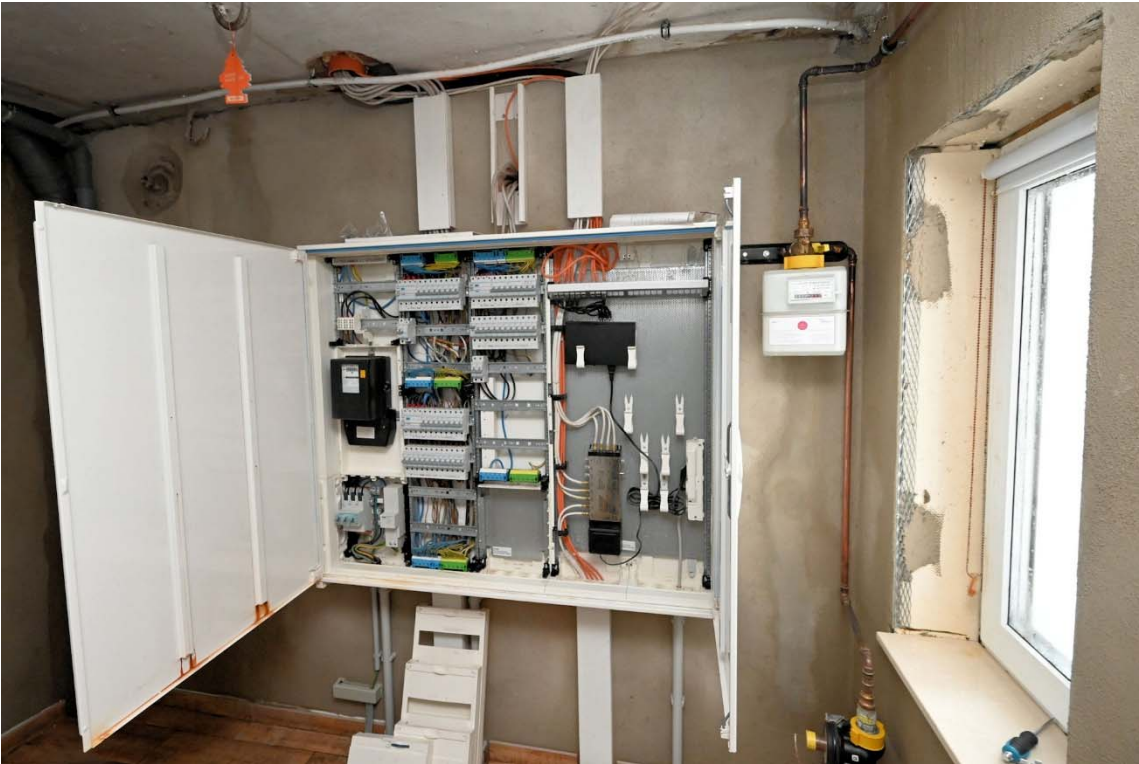
Abb. 15: Wohnhaus (A), Erdgeschoss, Hausanschluss-/ Heizungsraum, rechts das Fenster mit dem gefrorenen Wasser infolge Frostscha den Trinkwasserleitung
