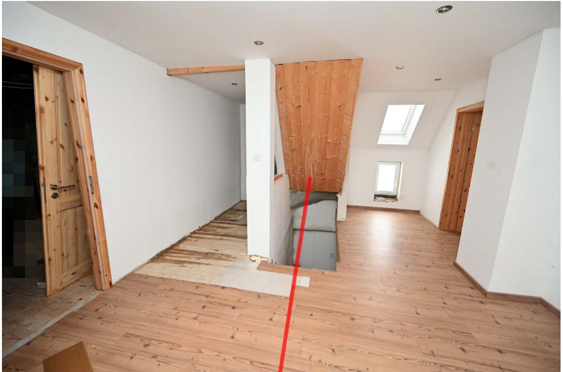
Abb. 25: Wohnhaus (A), Dachgeschoss, Flur (linke Trennwand: Fußboden mit starken Nässe Schäden infolge Frostscha den Trinkwasserleitung)
