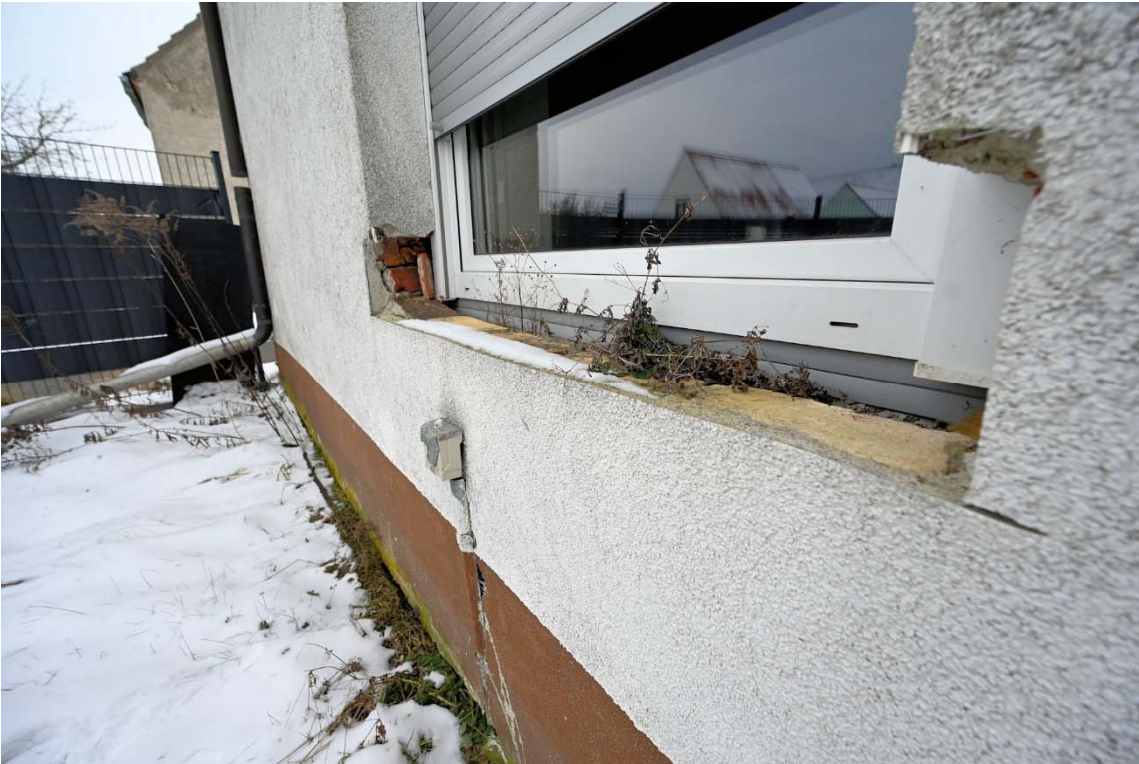
Abb. 7: Fenster Wohnzimmer, Fehlstellen Mauerwerk / Putz
