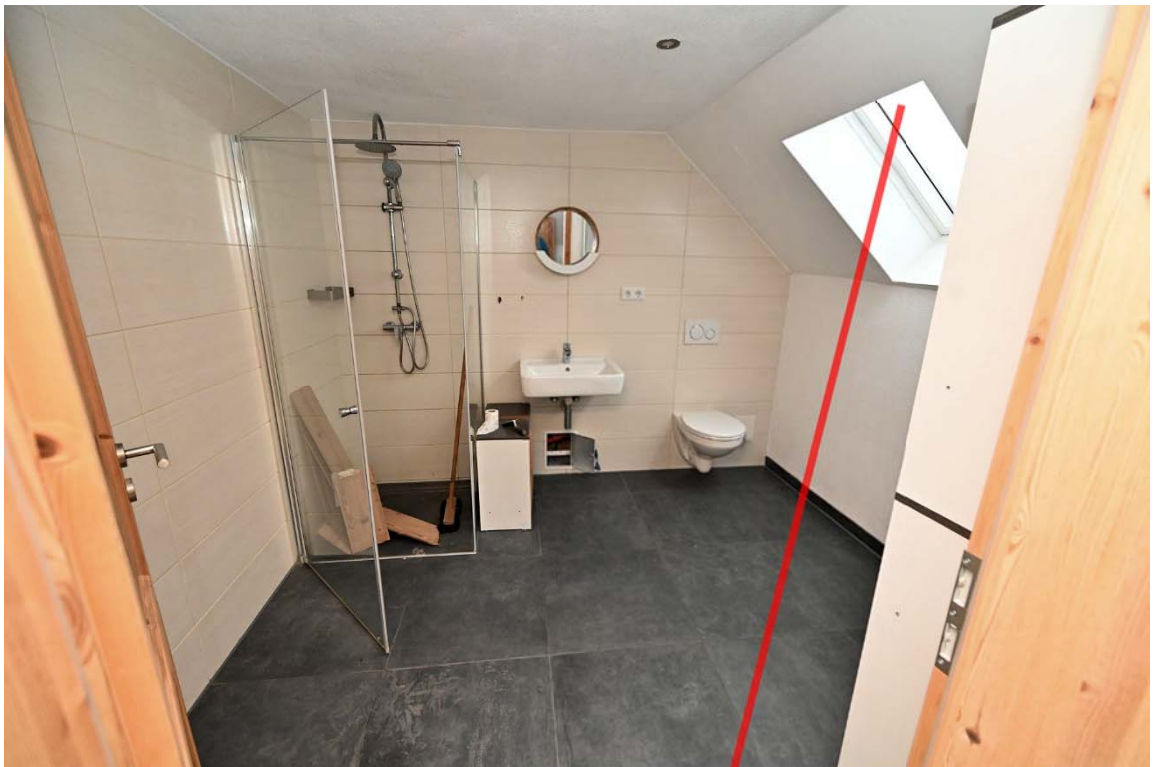
Abb. 29: Wohnhaus (A), Dachgeschoss, Dusche/WC, vermuteter Bereich Frostschaden Trinkwasserleitung (Fußboden gereinigt)
