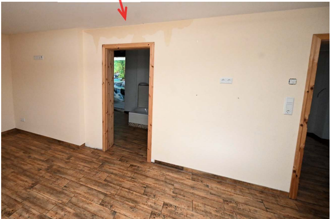
Abb. 22: Wohnhaus (A), Erdgeschoss, Küche, Durchfeuchtung über Türsturz zum Bad/WC infolge Frostschaden Trinkwasserleitung im DG
