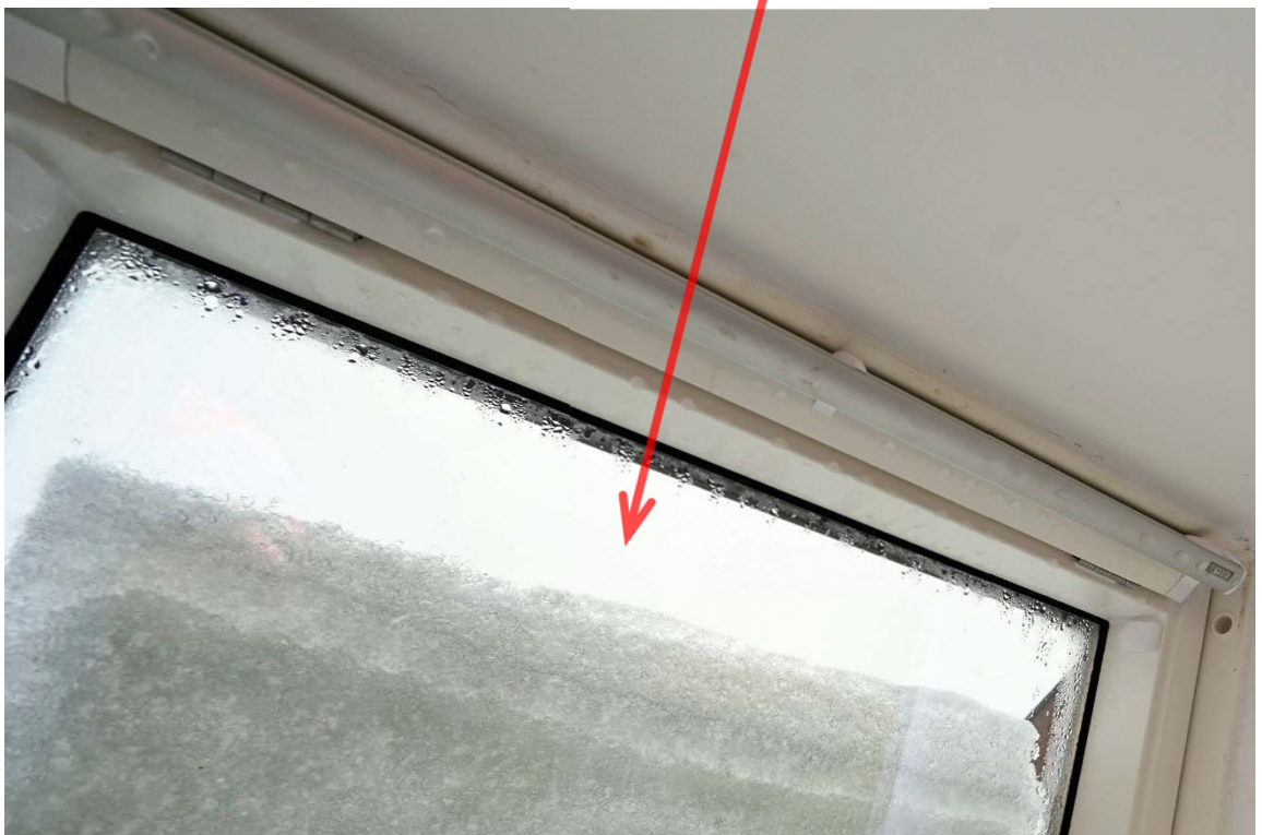
Abb. 30: Wohnhaus (A), Dachgeschoss, Dachflächenfenster Dusche/WC, umfangreiches Kondenswasser (infolge Frostschaden Trinkwasserleitung)
