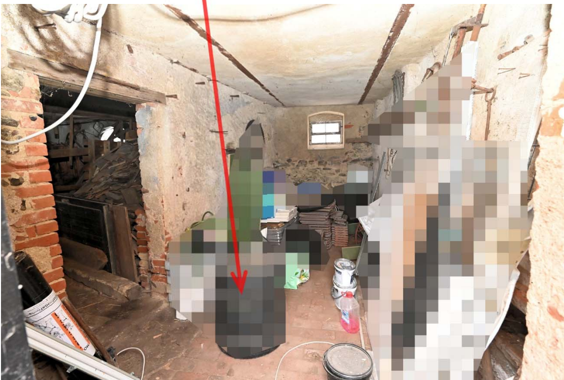
Abb. 44: ehem. Stall (C), Erdgeschoss, Reste an Baumaterialien (in der Bildmitte geringe Menge Dachziegel, links unten Schweißbahn)
