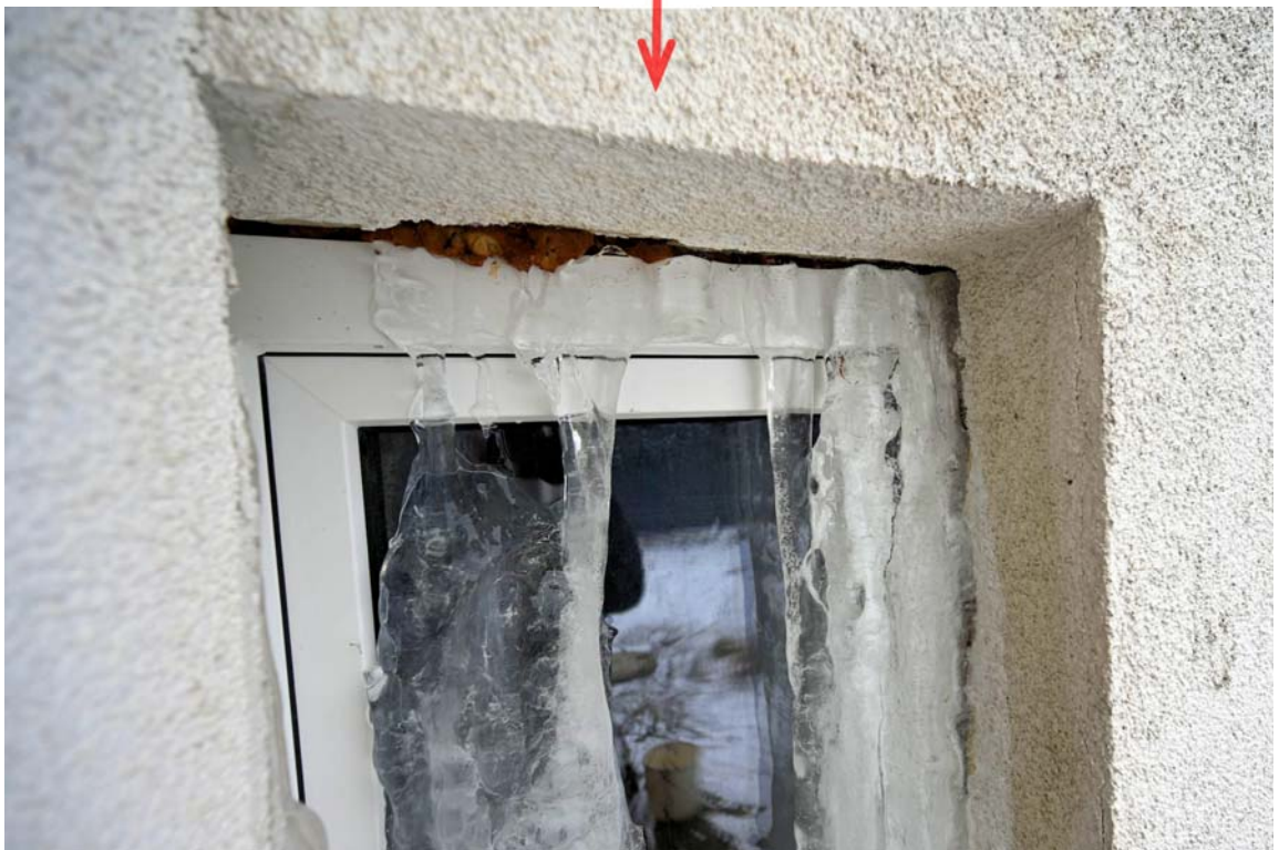
Abb. 10: Fenster mit gefrorenem Wasser infolge Frostscha den Trinkwasserleitung
