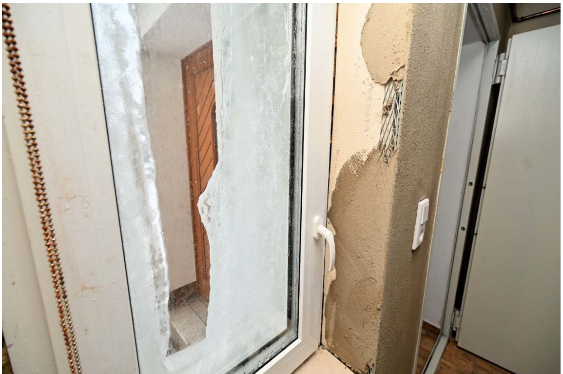
Abb. 14: Wohnhaus (A), Erdgeschoss, Hausanschluss-/ Heizungsraum, Fenster mit dem gefrorenen Wasser infolge Frostschaden Trinkwasserleitung
