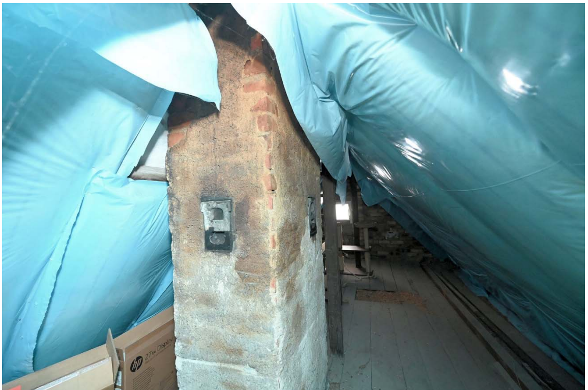
Abb. 34: Wohnhaus (A), Dachspitz, Schornstein versotten
