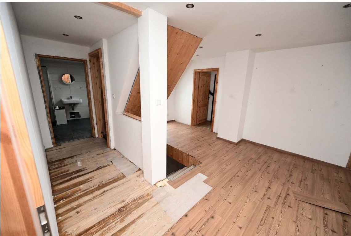
Abb. 28: Wohnhaus (A), Dachgeschoss, Flur, Fußboden zur Trennwand zum östlichen Zimmer mit starken Nässeschäden (Frostschaden Trinkwasserleitung)
