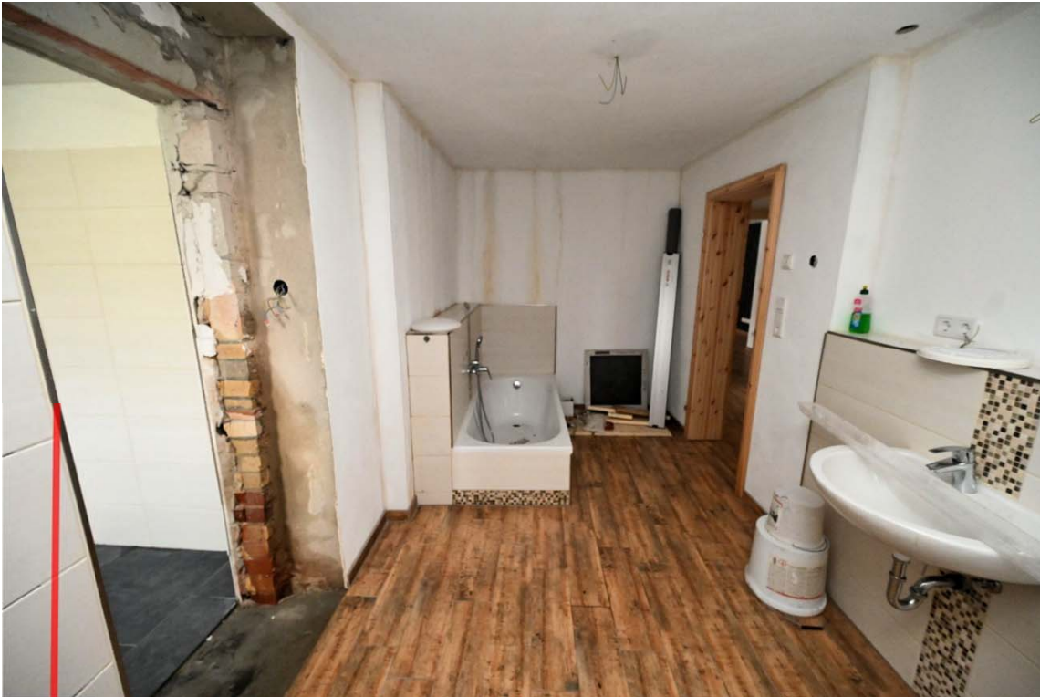
Abb. 23: Wohnhaus (A), Erdgeschoss, Bad/WC, massive Nässeschäden infolge Frostschaden Trinkwasserleitung im DG
