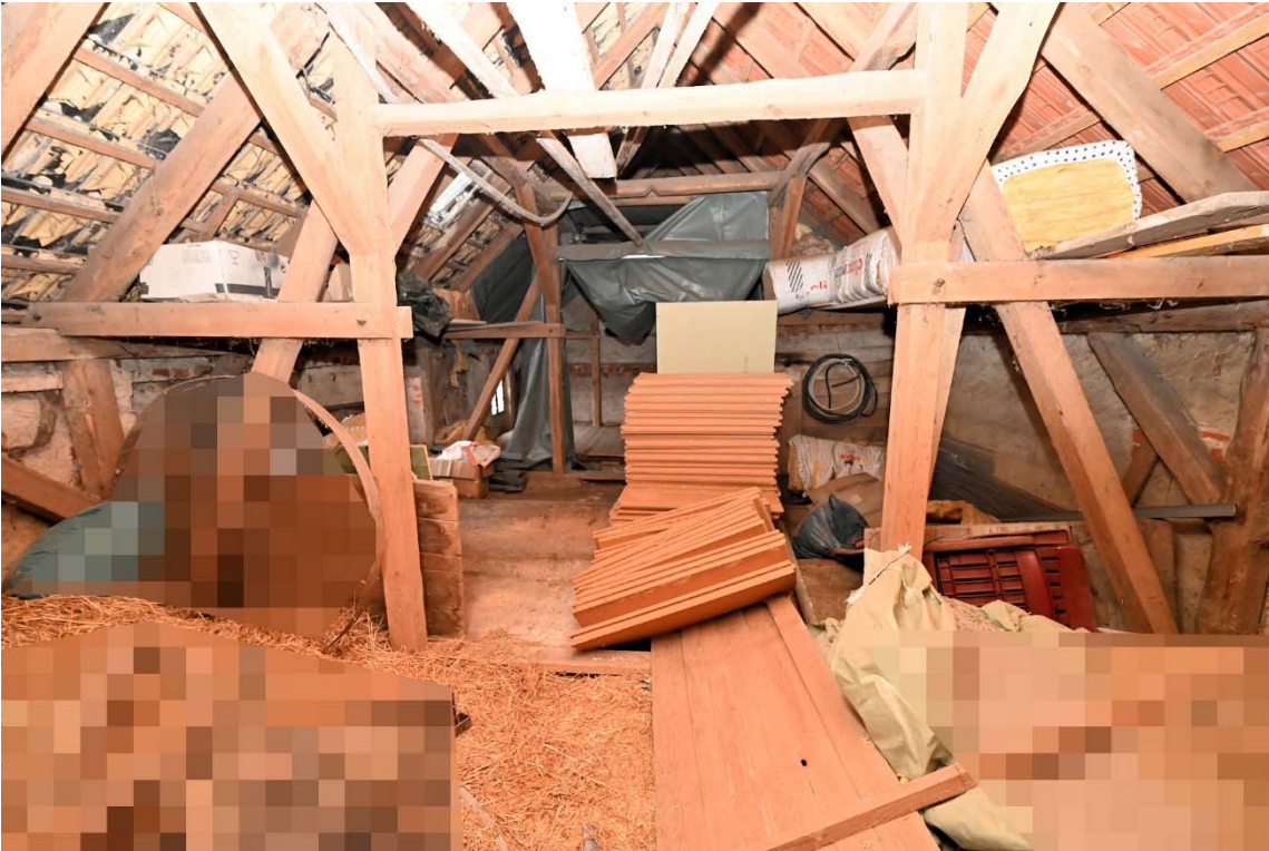
Abb. 47: ehem. Stall (C), Dachgeschoss, Reste an Baumaterialien (hier Dämmstoffe)
