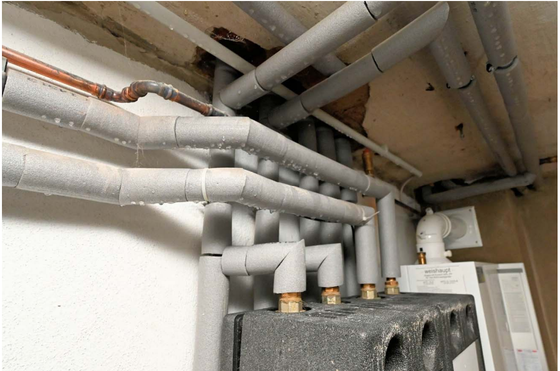
Abb. 13: Wohnhaus (A), Erdgeschoss, Hausanschluss-/ Heizungsraum, umfangreiches Kondenswasser (infolge Frostschaden Trinkwasserleitung)
