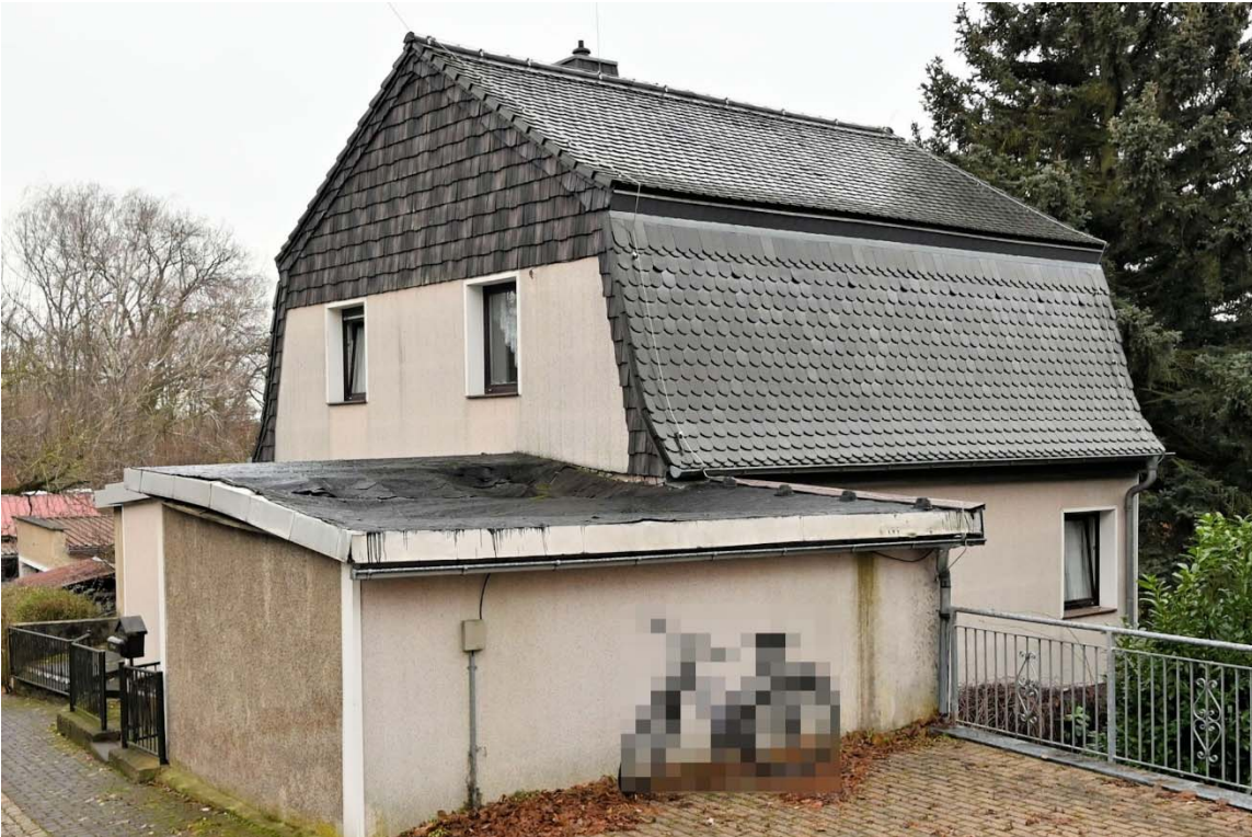
Abb. 3: Flurstück 89, Gebäudeansicht vom Heideweg, im Vordergrund ehem. Gästezimmer (so gen. Garage) mit teileingestürztem Dach
