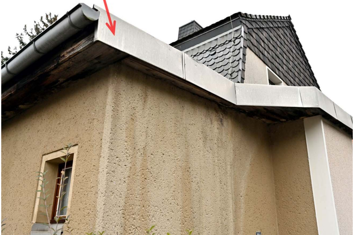
Abb. 6: Flurstück 89, Gebäudeansicht vom Heideweg, Detail ältere Nässeschäden einer früheren Dachundichtigkeit (so gen. Kohlebunker (KG) mit Zimmer (EG))
