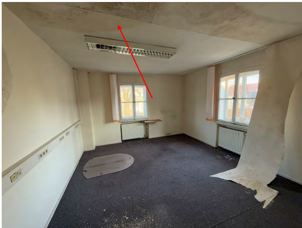
Flurstück 620; Raum 3 im Obergeschoss mit feuchtem Deckenbereich (Pfeil) ...
