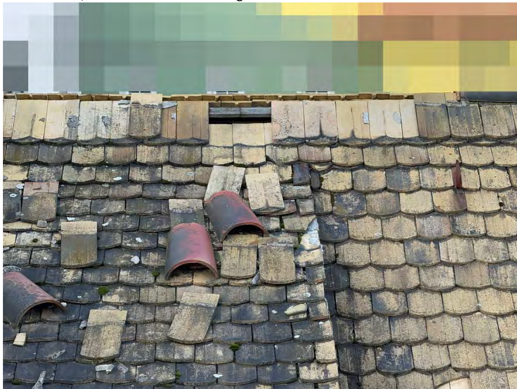
... mit undichter Dacheindeckung und kaputten Dachziegeln an etlichen Stellen
