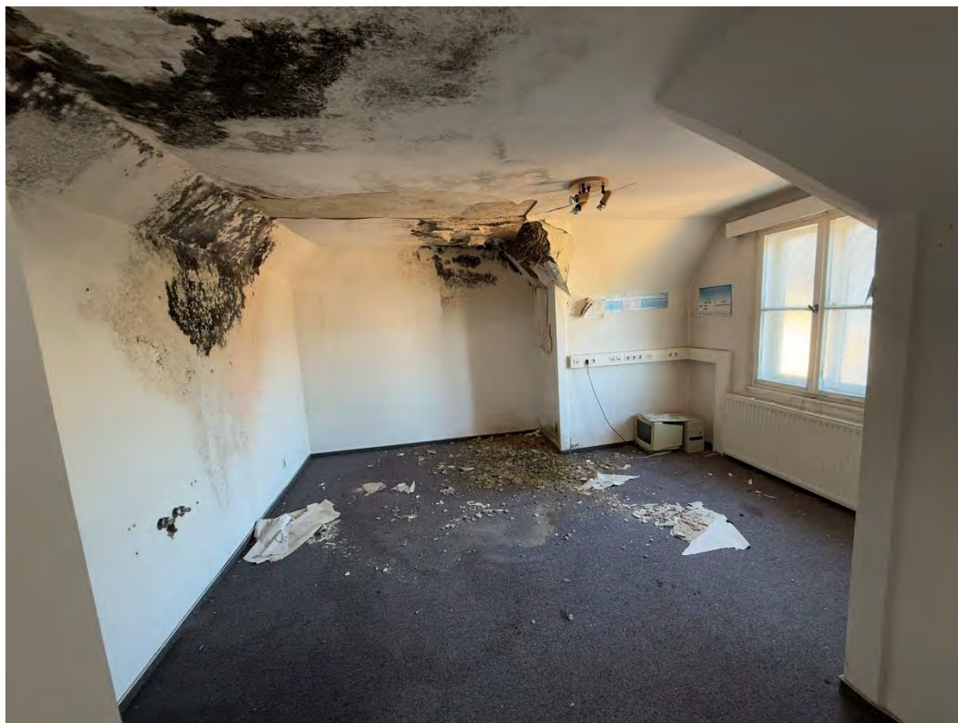
Flurstück 620; Raum 1 im Dachgeschoss mit dunkel verfärbten Deckenbereichen
