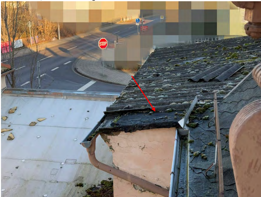
... infolge undichter Dacheindeckung
