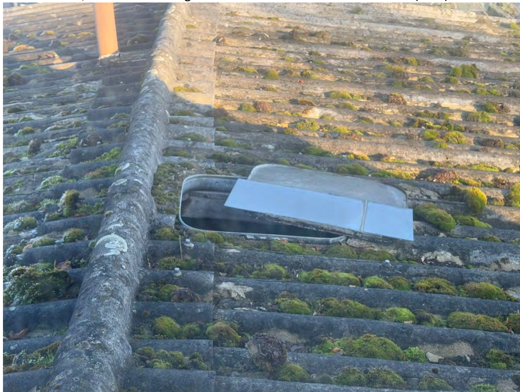
... infolge offenstehender Dachluke
