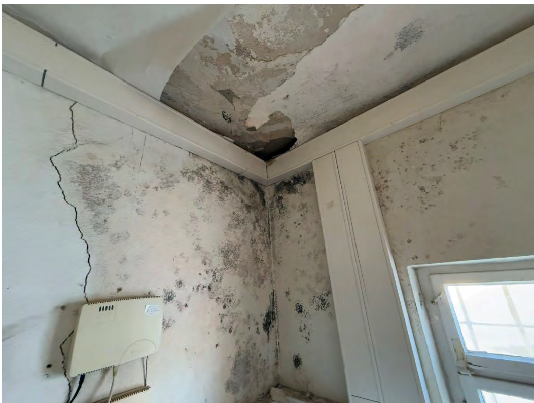
Flurstück 620; Raum 5 im Obergeschoss mit dunkel verfärbter Decke ...
