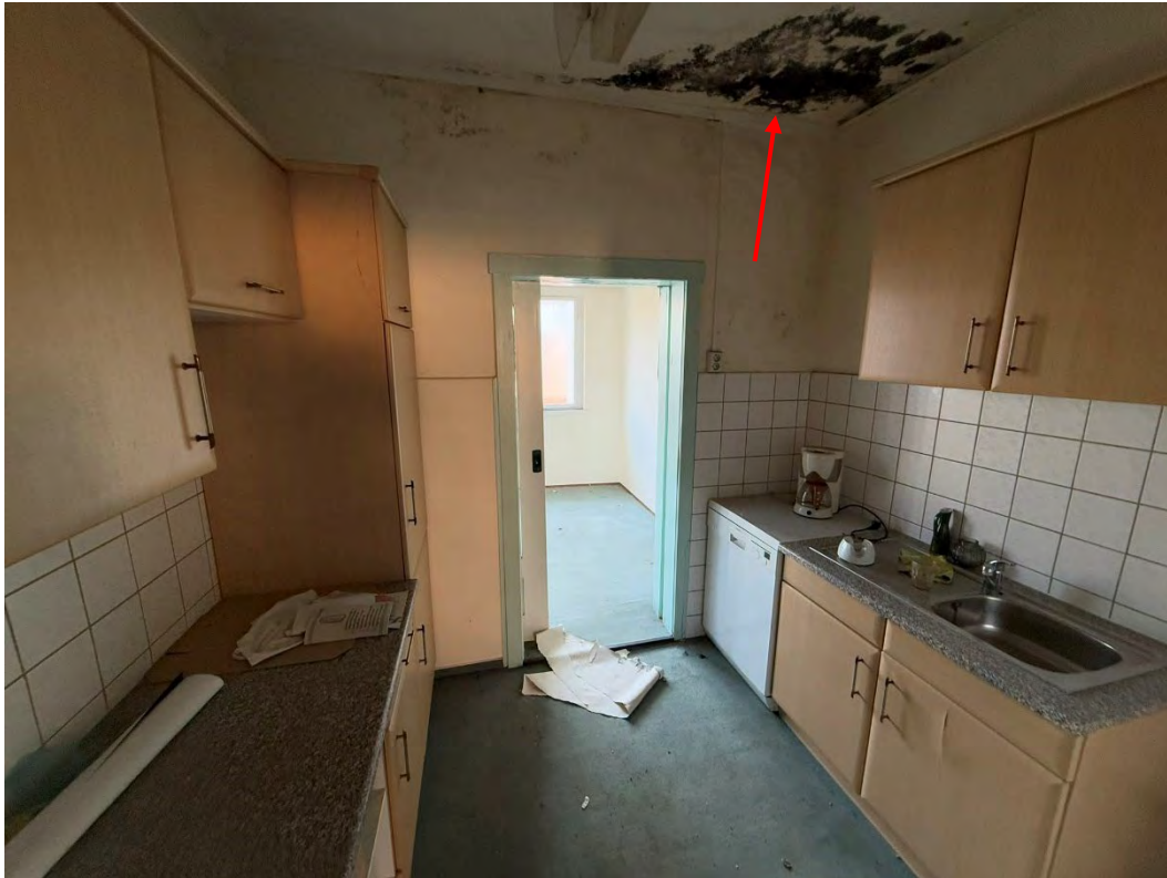
Flurstück 620; Küche im Obergeschoss mit dunkel verfärbter Decke infolge Einregnung
