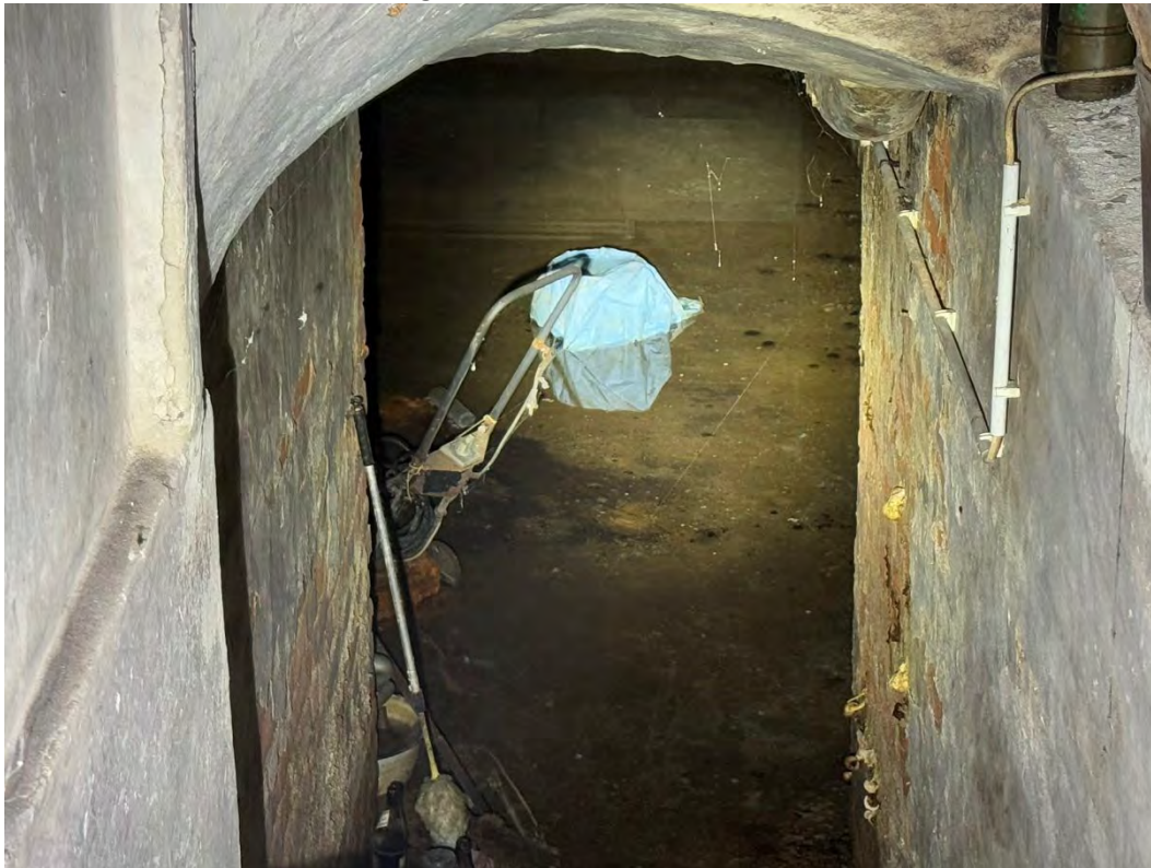
Flurstück 620; stehendes Wasser im Kellerbereich
