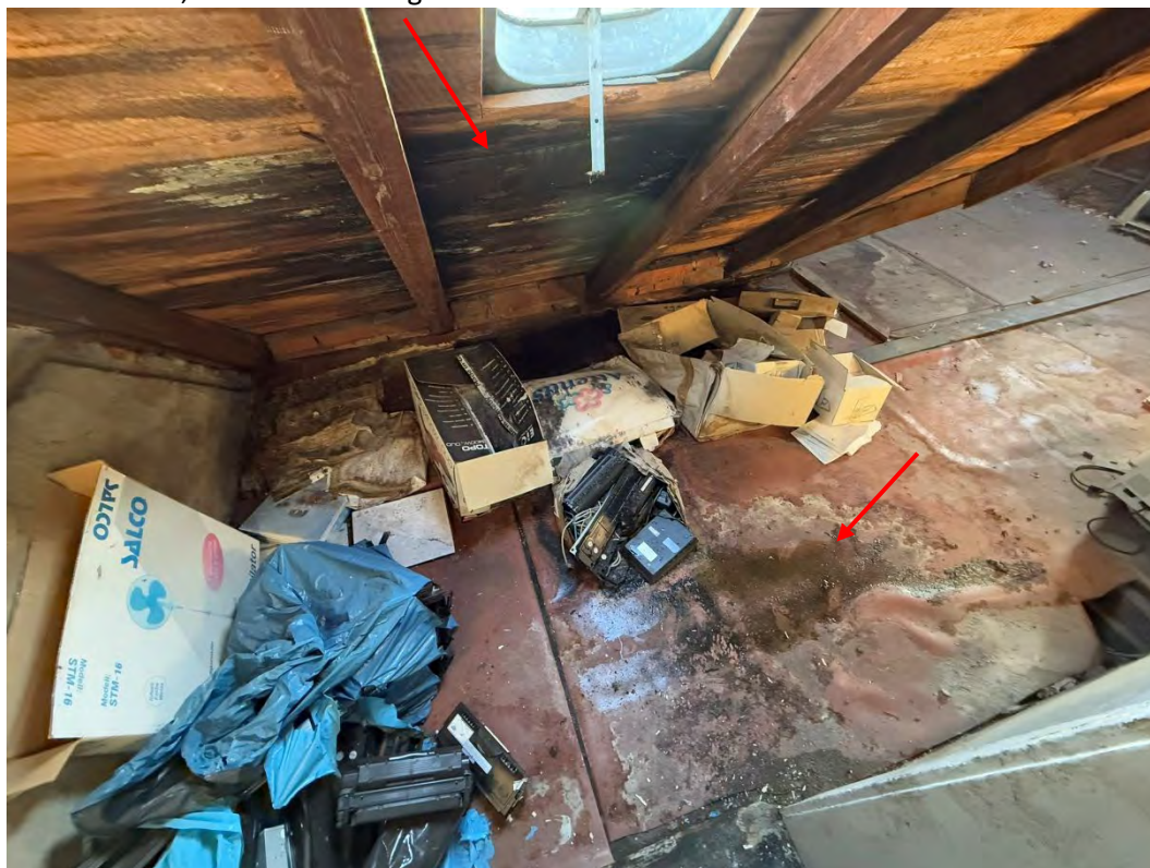
Flurstück 620; Dachboden mit Pfützenbildung und dunkel verfärbter Dachschalung
