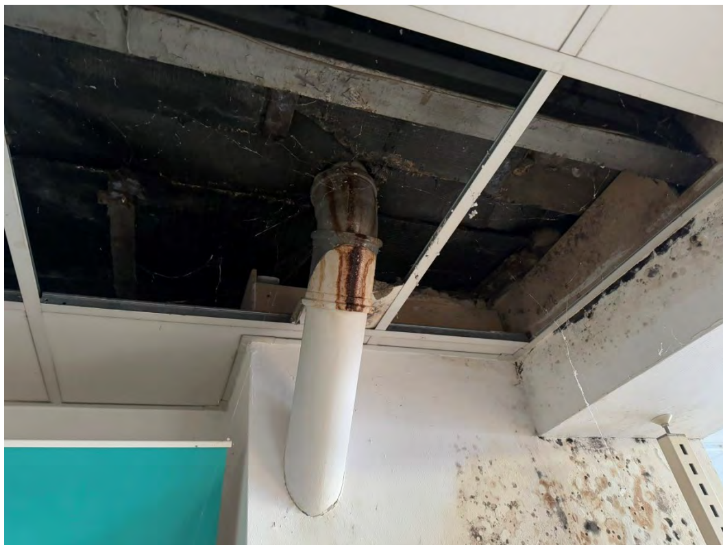
Flurstück 620; undichte innenliegende Dachentwässerung ...
