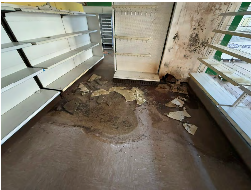
Flurstück 620; Einregnungsstelle im Verkaufsraum wegen undichter Dachabdichtung
