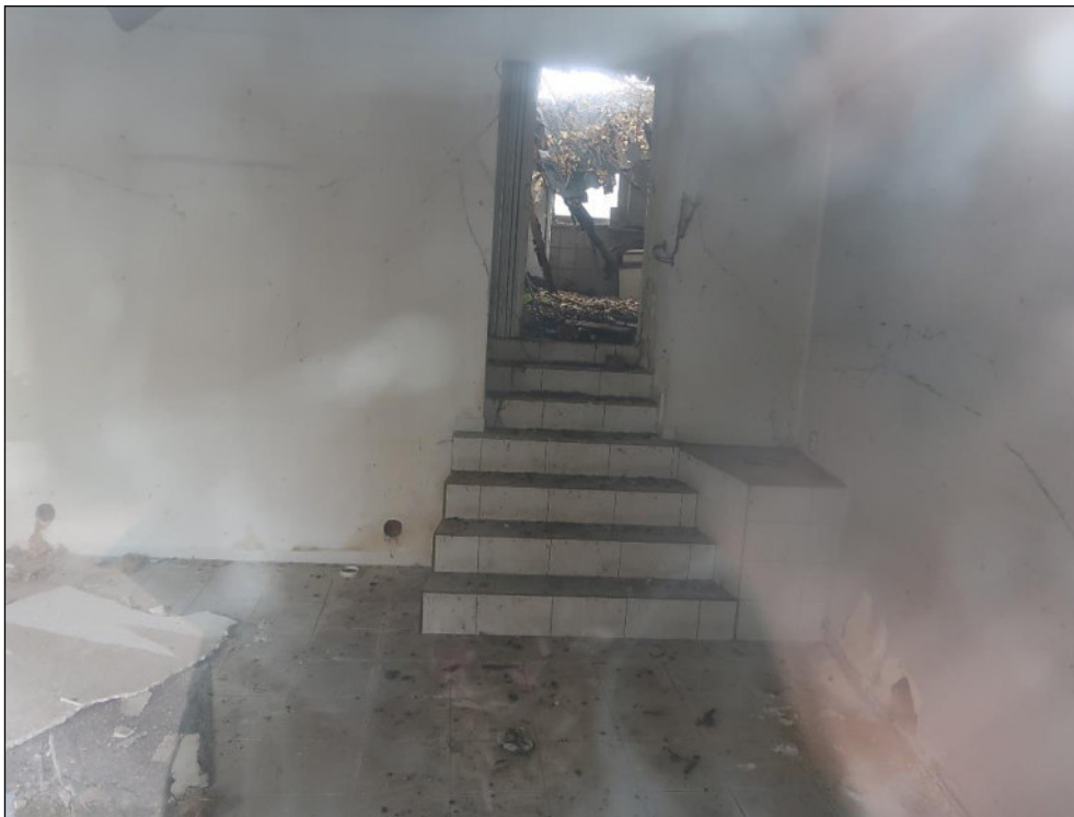
Bild 6: Blick durch das Schaufenster der Ladeneinheit / im Hintergrund eingestürztes Dach des hofseitigen Anbaus
