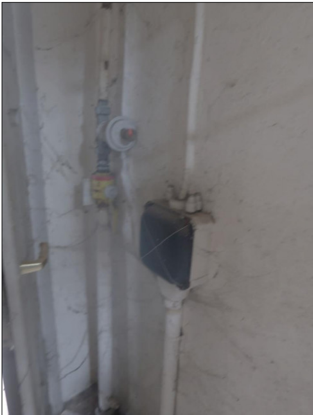
Bild 21: Gas-Hausanschluss im EG
