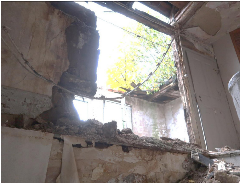
Bild 18: Blick vom Treppenhaus auf die eingestürzten hofseitigen Anbauten
