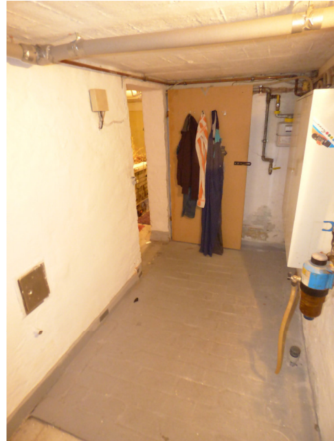
Bild 18: Hausanschlussraum im Keller
