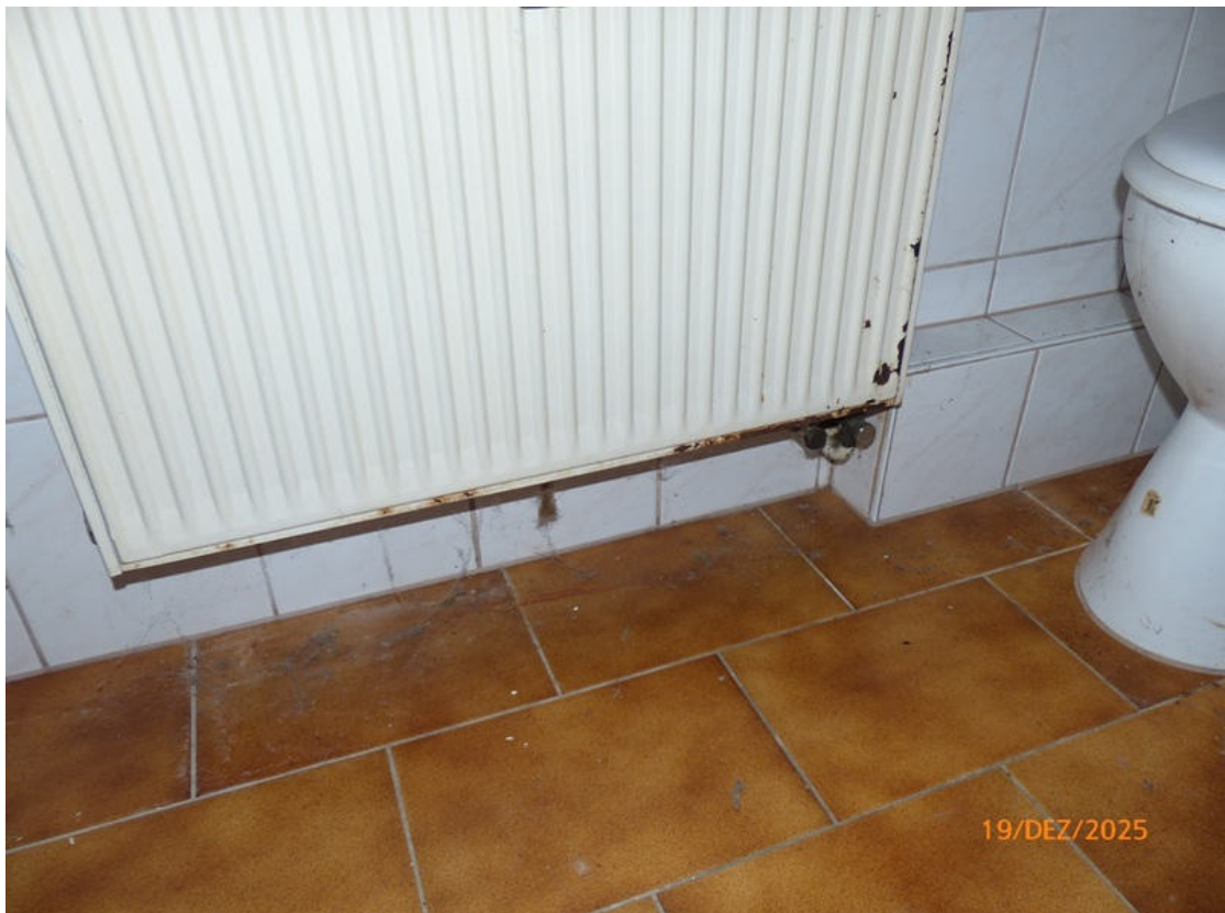
Foto 54: Rostspuren am Badheizkörper
