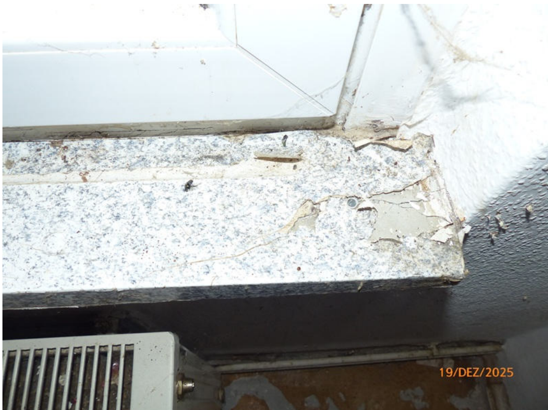
Foto 61: beklebte Fensterbank in der Küche
