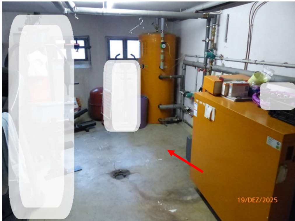
Foto 22: Heizungsraum im Keller
