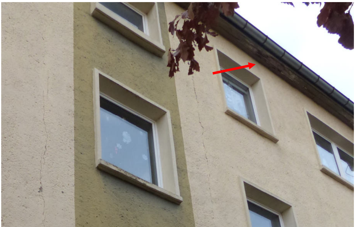
Foto 39: Nässespuren am hofseitigen Dachkasten Haus 5d
