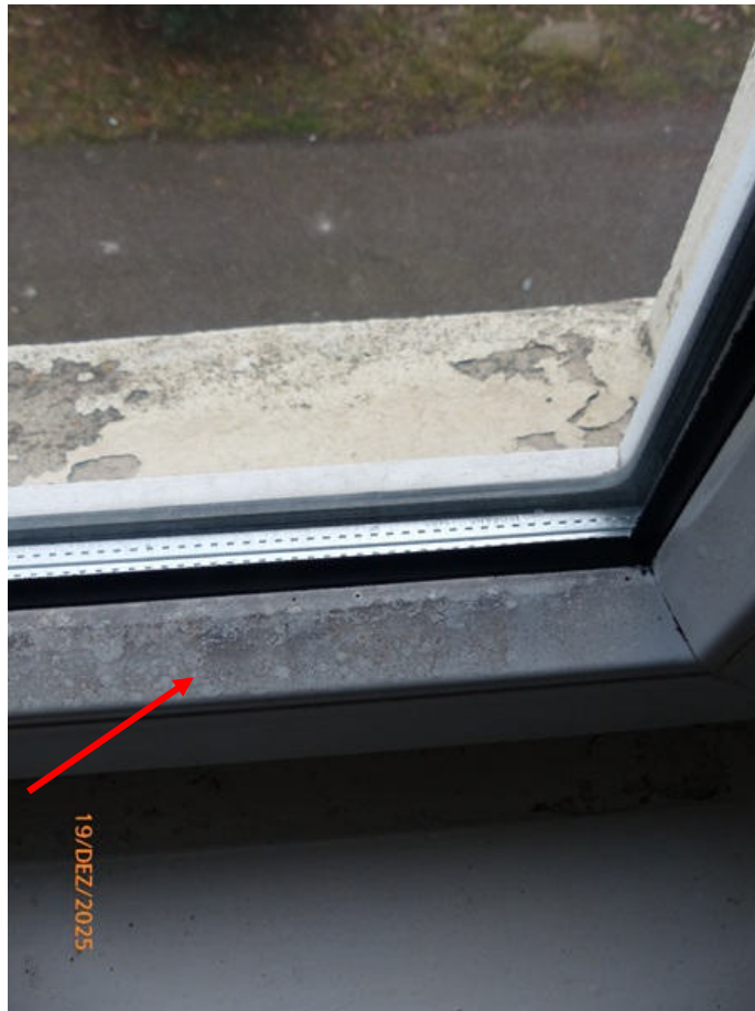
Foto 60: Verfärbung des Fensterschenkels im Kinderzimmer
