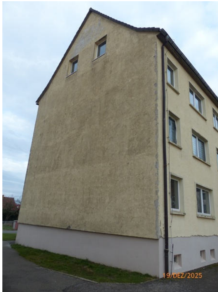
Foto 38: verschmutzter Westgiebel mit Farb- und Putzabplatzungen
