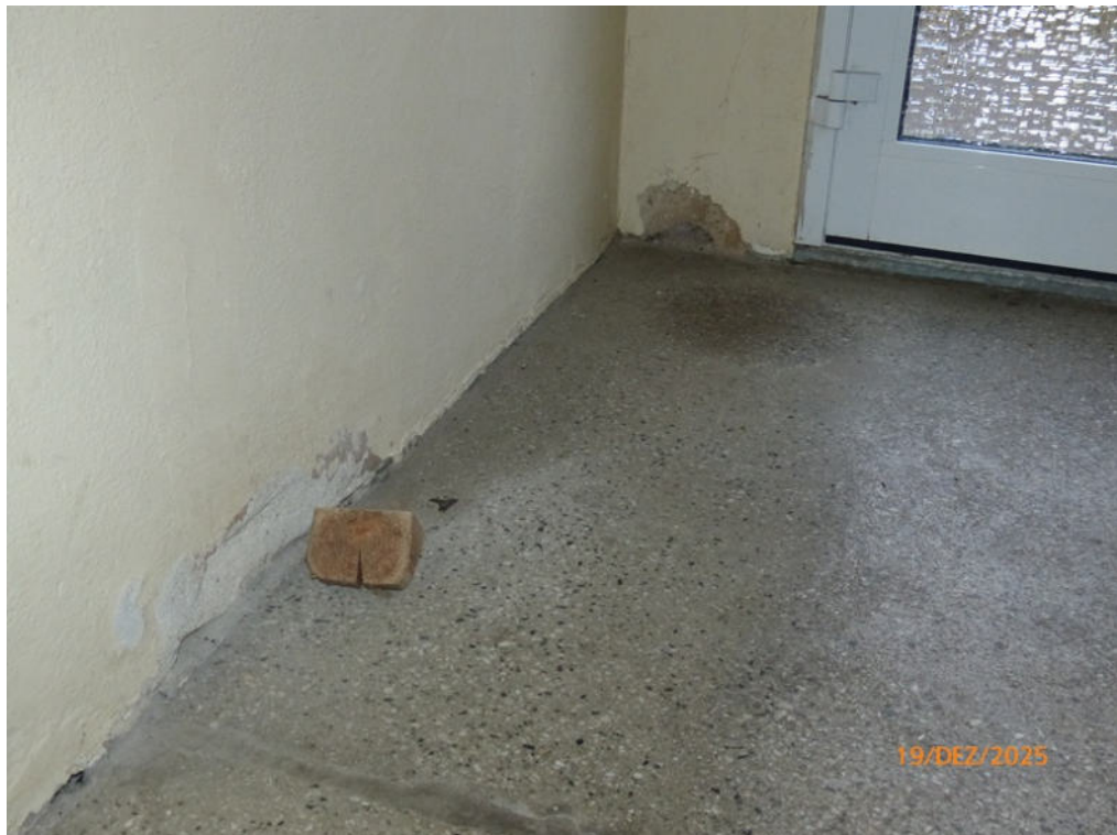
Foto 30: Farbabplatzungen im Hauseingangsbereich Nitzschkaer Straße 5d
