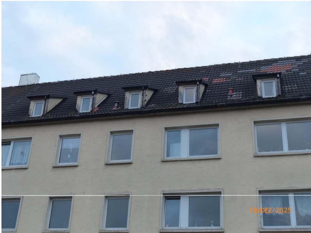
Fotos 36 und 37: Farbabplatzungen an den Wangen der Dachgauben
