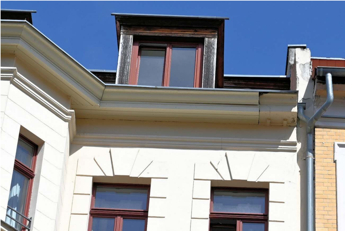
Abb. 23: Gemeinschaftseigentum, Fassade zur Wittstockstraße, Detail Putzriss u. a.
