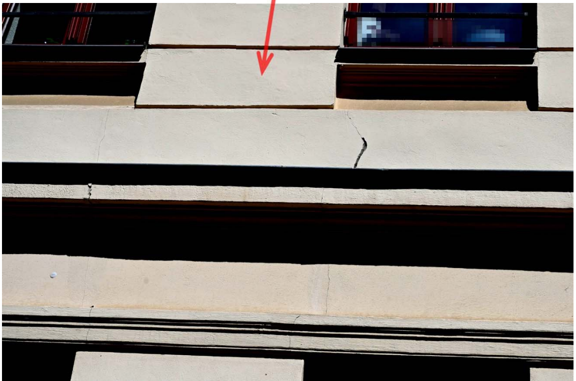
Abb. 22: Gemeinschaftseigentum, Fassade zur Wittstockstraße, Detail Putzriss (Abbildung kontrastverstärkt)
