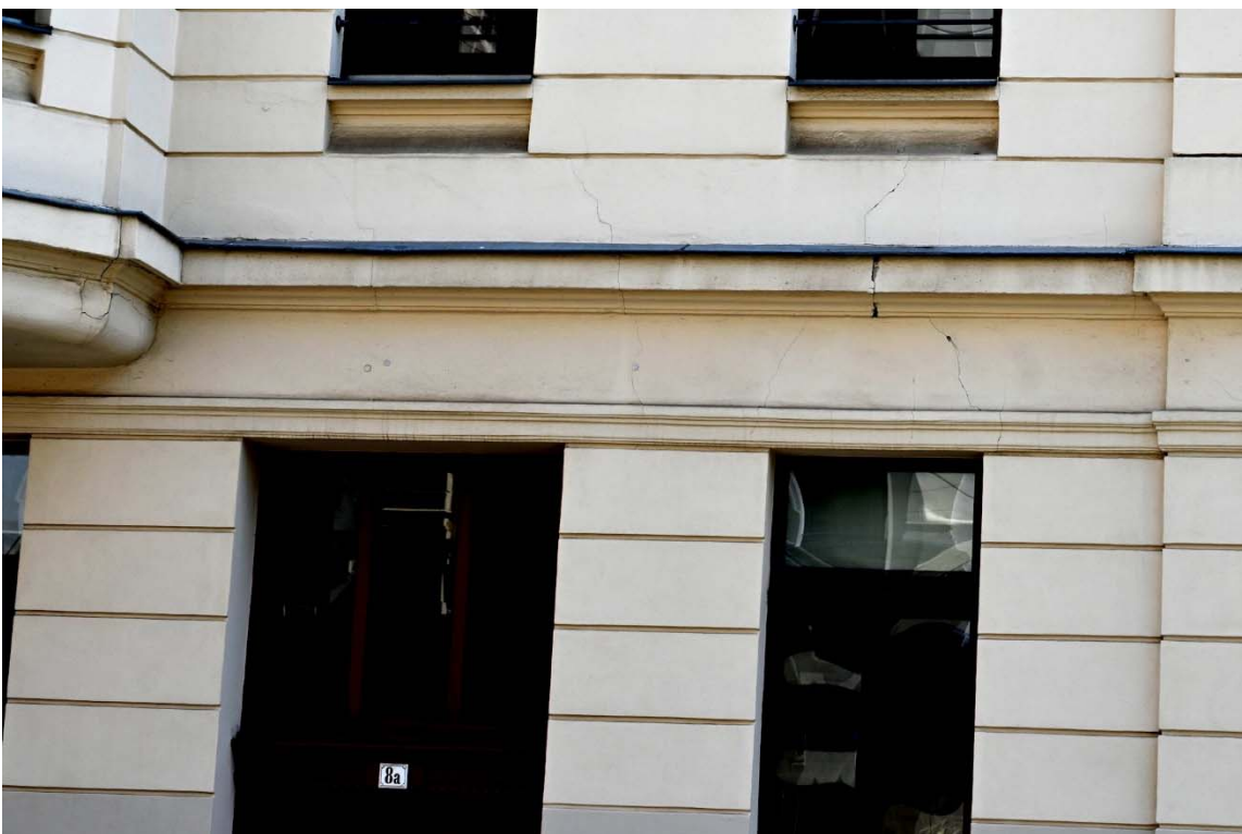
Abb. 24: Gemeinschaftseigentum, Fassade zur Kippenbergstraße im Bereich des Haus- eingangs, Detail Putzrisse (Abbildung kontrastverstärkt)
