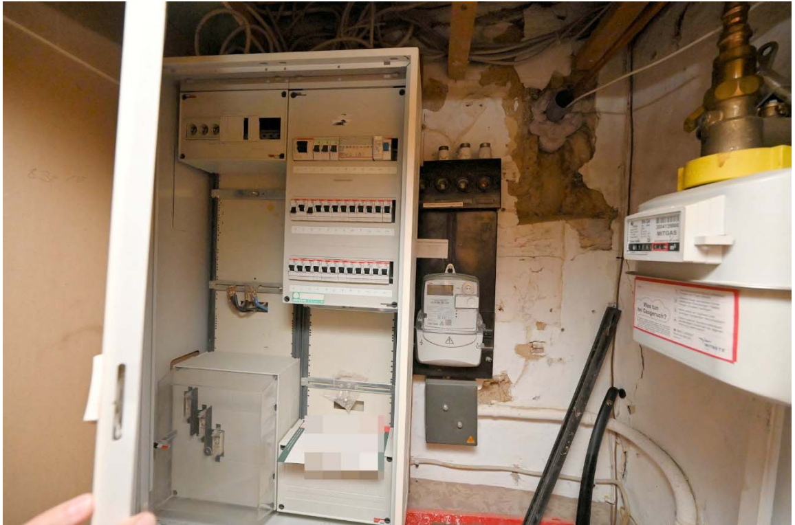
Abb. 5: Erdgeschoss, Hausflur, Hausanschlüsse und Sicherungskasten
