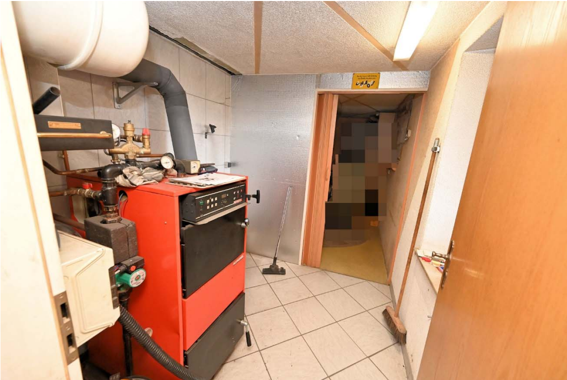
Abb. 11: Erdgeschoss, Raum Heizkessel
