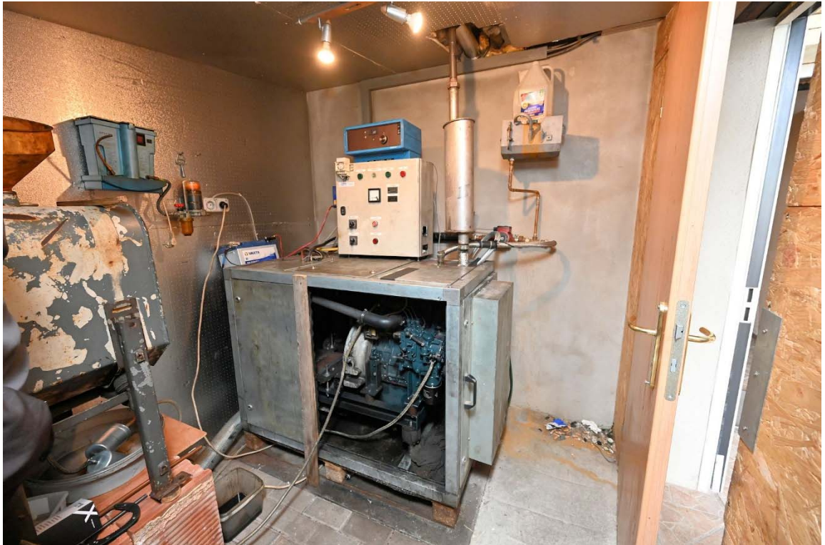
Abb. 33: Nebengebäude D, Stromgenerator als mögl. Zubehör
