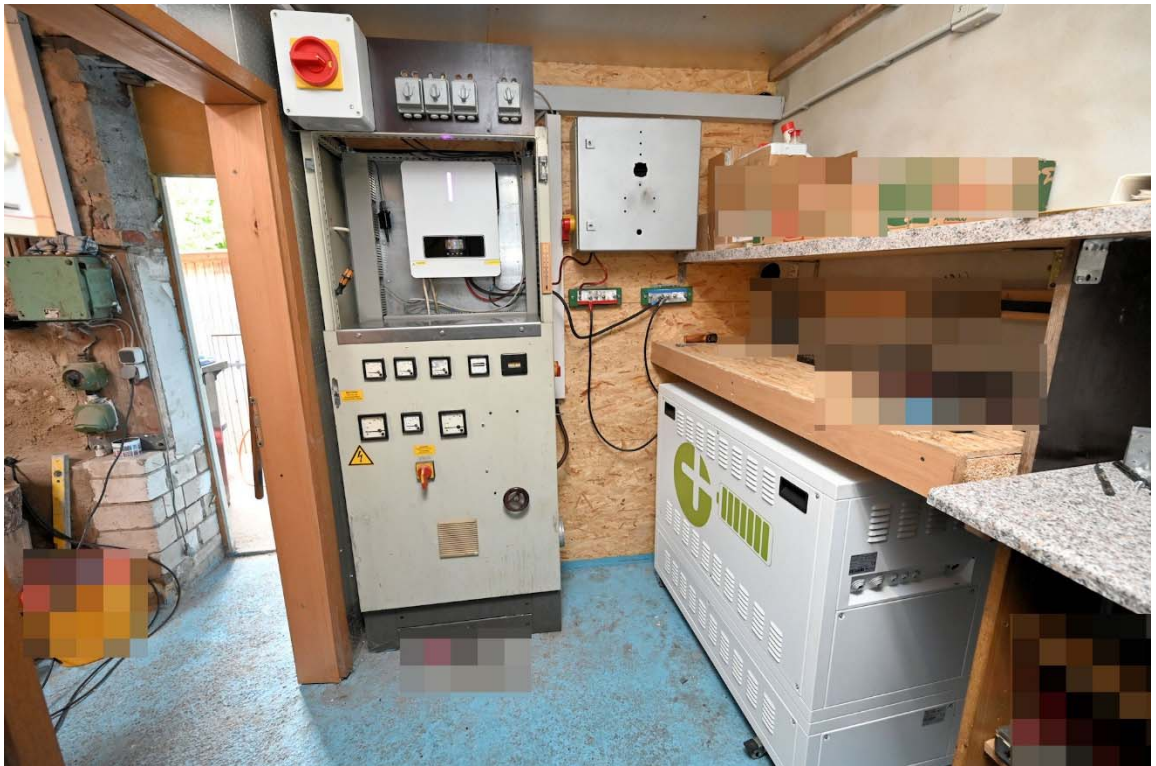
Abb. 29: Nebengebäude B, Stromanlagen (Wechselrichter und Stromspeicher als mögl. Zubehör)
