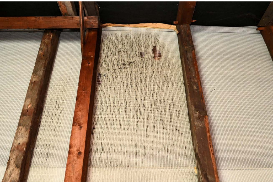
Abb. 24: Dachgeschoss, Unterspannbahn zur Straße im Lichteinfallbereich stark porös
