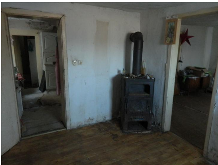
Abb. 5: Wohnräume im Erdgeschoss des Wohnhauses; Innenausstattung vollständig verschlissen
