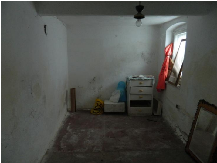
Abb. 4: Wohnraum im Erdgeschoss; massive Putz- und Mauerwerksschäden durch aufsteigende Feuchtigkeit
