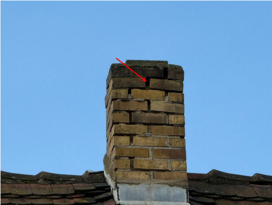
sanierungsbedürftige Kaminköpfe sowie überalterte Dacheindeckung
