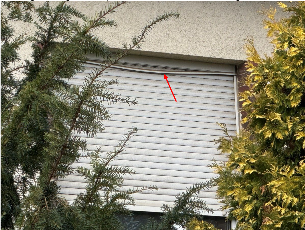
Beschädigung am Rollladenkasten an der Straßenfassade (Obergeschoss)
