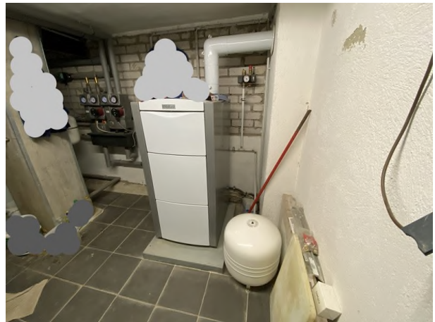
Heizungsraum mit Heiztherme
