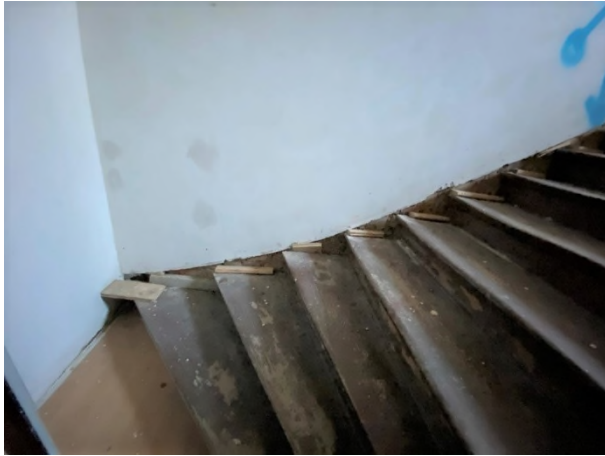
zu stabilisierender Treppenlauf
