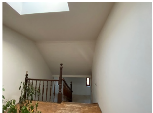
Treppenhaus DG, Fenster ohne RWA
