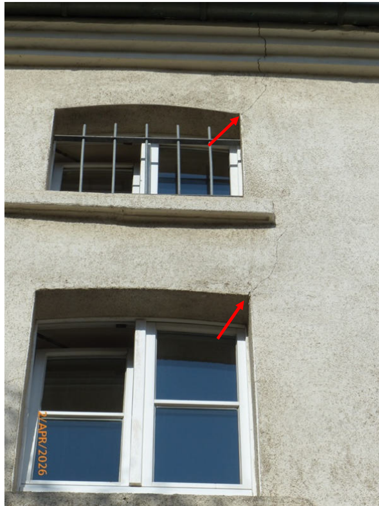
Fotos 35, 36 und 37: Risse an hofseitiger Fassade – Bereich Treppenhaus
