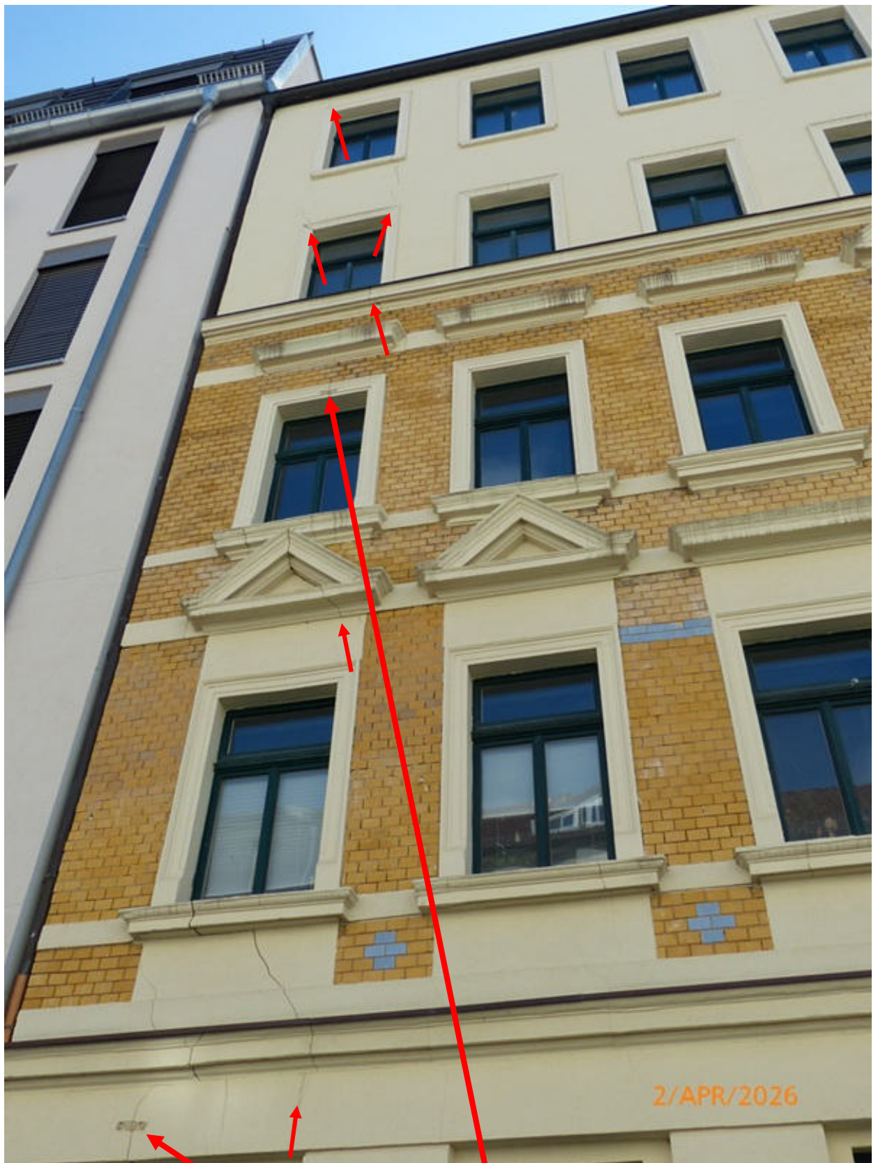
Foto 43: zahlreiche Fassadenrisse straßenseitig
