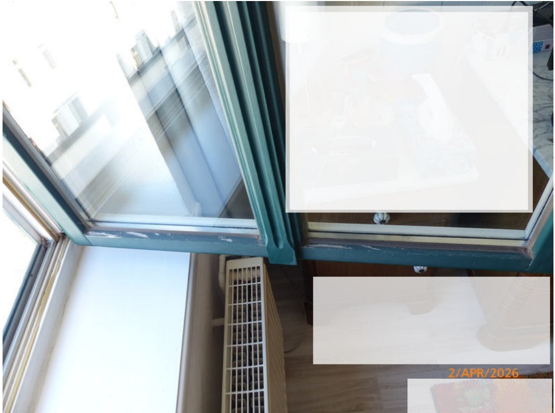
Foto 46: Farbabplatzungen Wetterschenkel am straßenseitigen Wohnraumfenster Wohnung Nr. 10
