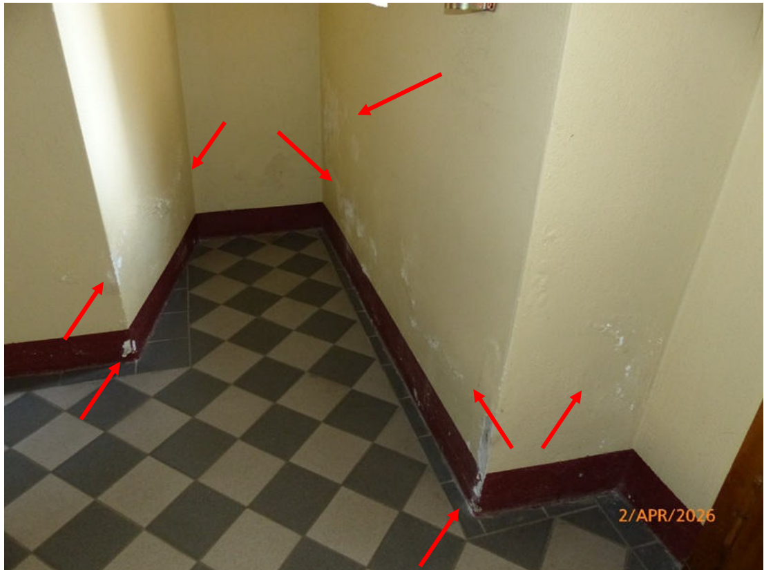
Fotos 28, 29: Farb-/Putzabplatzungen sowie Aussalzen im TH/Hofausgangsbereich
