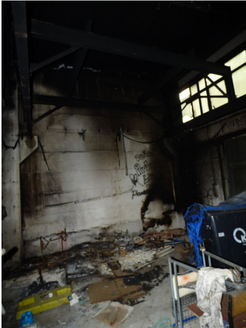
Bild 13: nördlicher Gebäudebereich des Heizhauses mit Brandschaden
