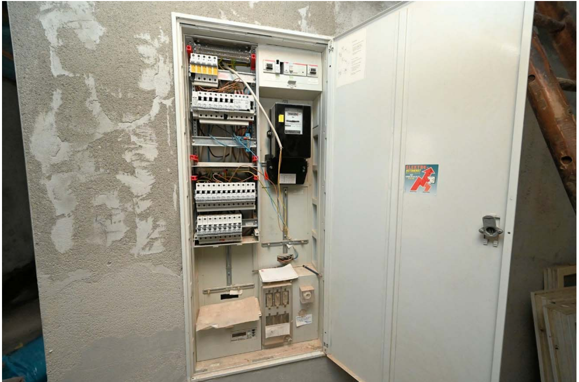
Abb. 9: Wohnhaus, Erdgeschoss, Flur, Detail Sicherungskasten
