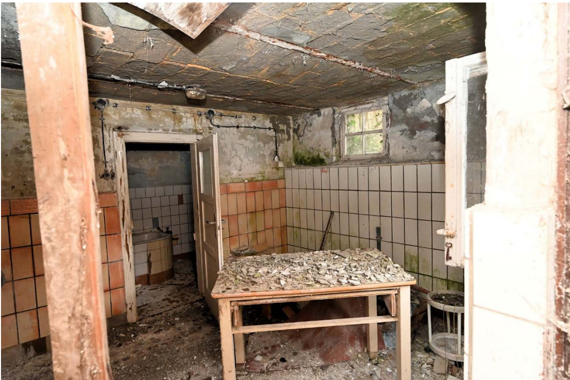
Abb. 24: ehem. Stall, bauliche Erweiterung, starke Einregnung, Decke tw. kollabiert
