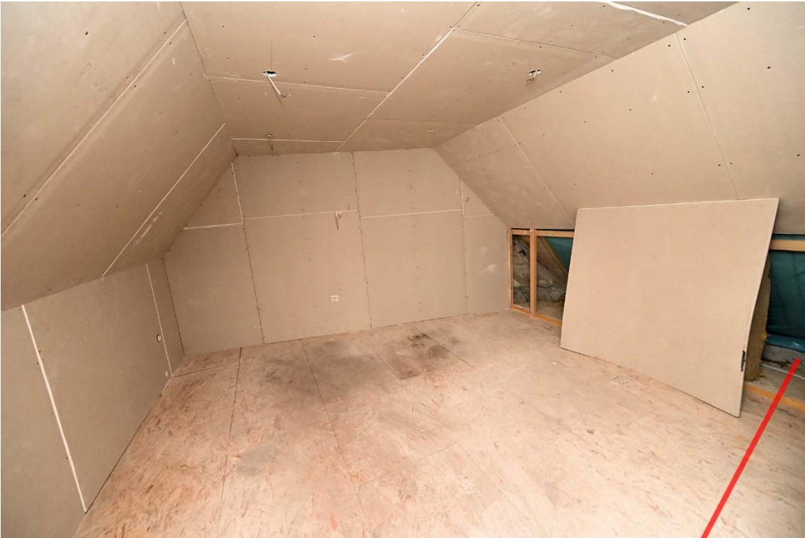
Abb. 19: Wohnhaus, Dachgeschoss, nördliches Zimmer (ein Dachflächenfenster mit Gipskarton verblendet)
