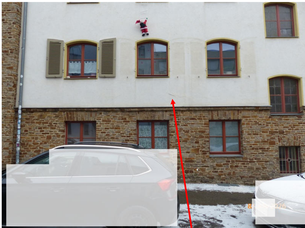
Fotos 31 und 32: Putzriss in der Fassade – Slevogtstraße 26 a
