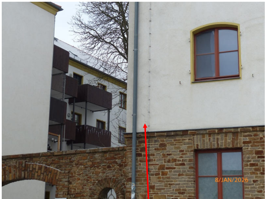
Fotos 33 und 34: Putzriss in der Fassade – Bucksdorffstraße 24
