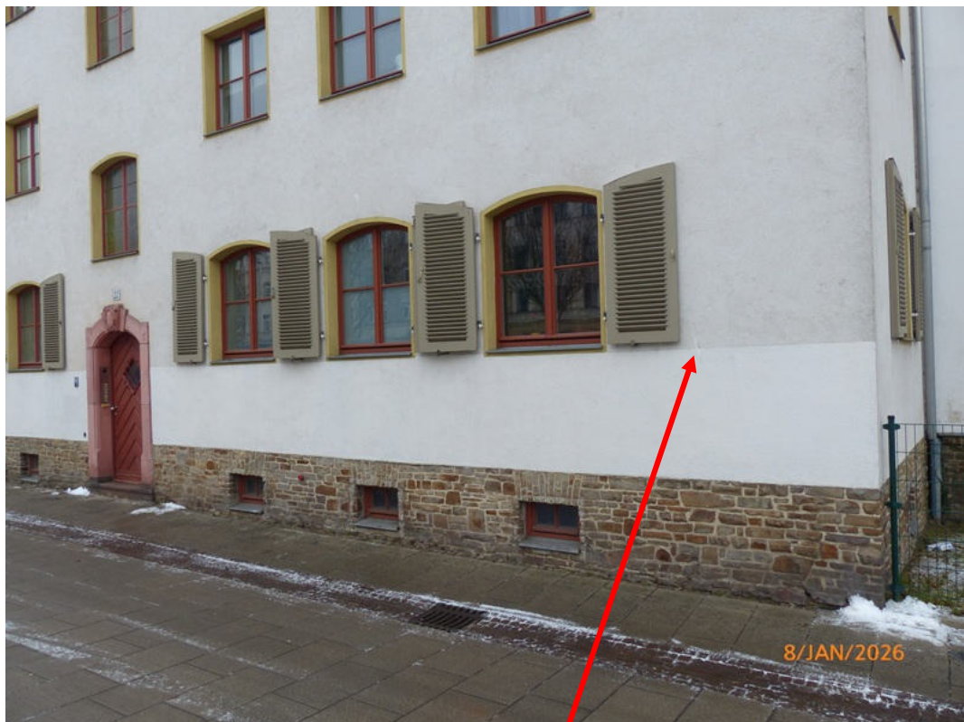
Fotos 37 und 38: Putzabschürfung Fassade Knopstraße 27
