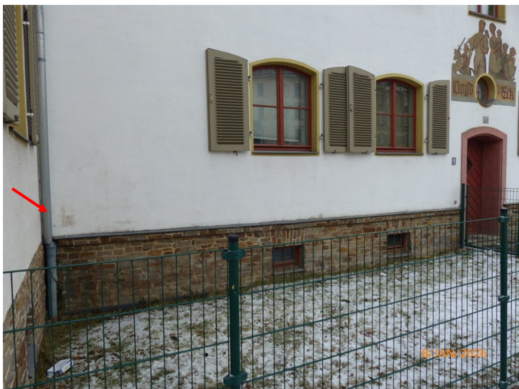
Foto 36: Farbabplatzungen/-auswaschungen – Fassade Knopstraße 29
