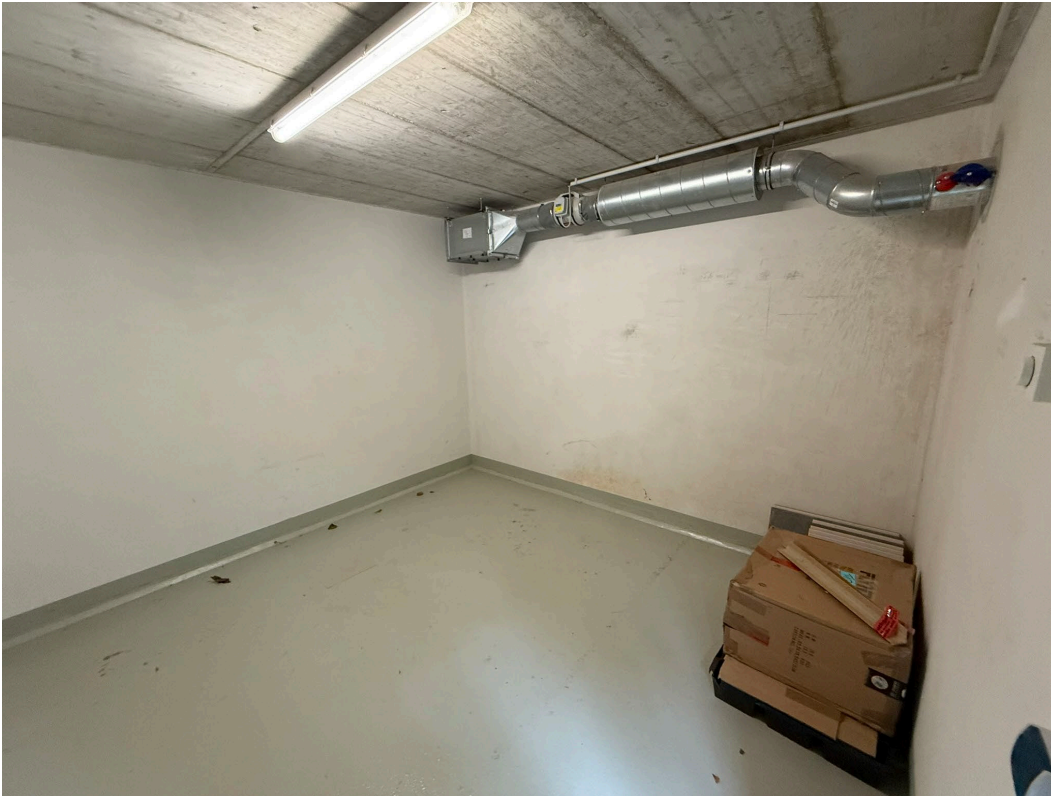
Mülltonnenraum (Gemeinschaftseigentum) mit Abluftanlage
