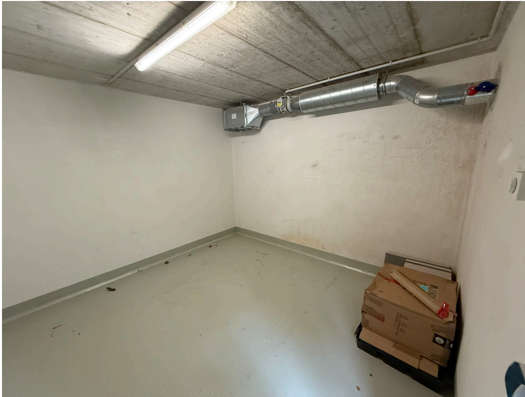
Mülltonnenraum (Gemeinschaftseigentum) mit Abluftanlage
